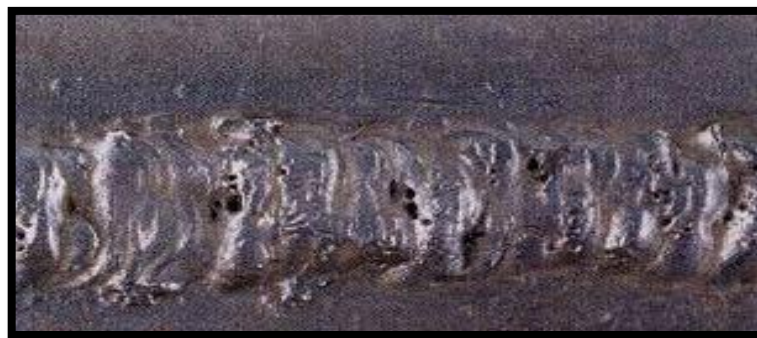
Figura 51 Porosidad en la soldadura
