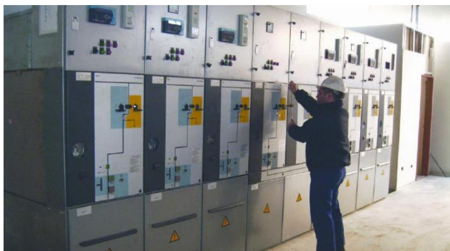
Figura 1: Subestación eléctrica. Fuente: Montecelos.
