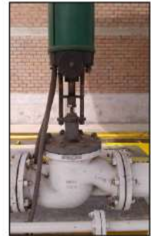
VALVULA DE DESPACHO
