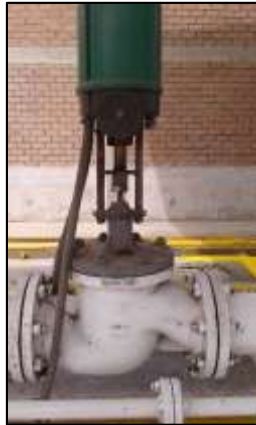
FIGURA 2.14: Válvulas de despacho a cisternas
