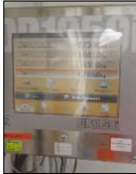
FIGURA 3.107: Controlador de pesaje de las Balanzas
