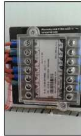
MEDIDOR DE ENERGIA
