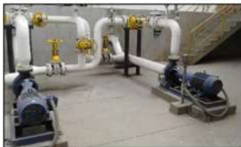
BOMBAS Y TUBERIAS
