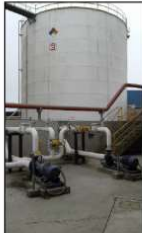
VISTA DE BOMBAS
