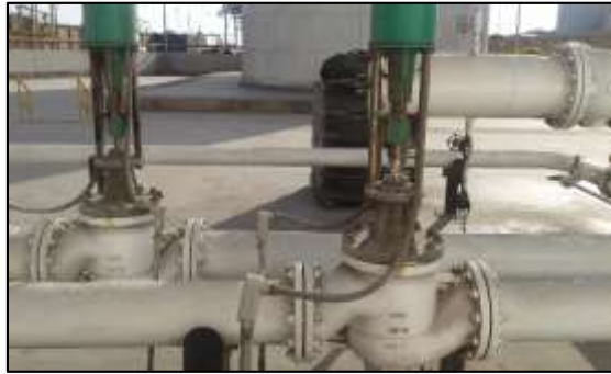
FIGURA 2.13: Válvulas de suministro a los tanques
