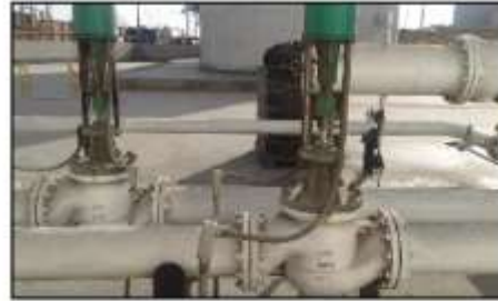
VALVULAS DE TANQUES
