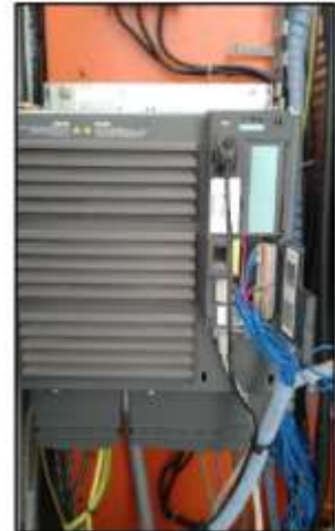
MODULO DE POTENCIA
