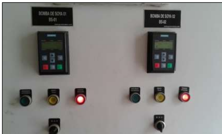
FIGURA 3.72: Vista frontal del tablero eléctrico de las bombas
