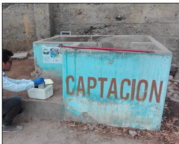
Figura 9. Toma de muestra en la zona de captación del CITRAR (1) Fuente: Elaboración propia
