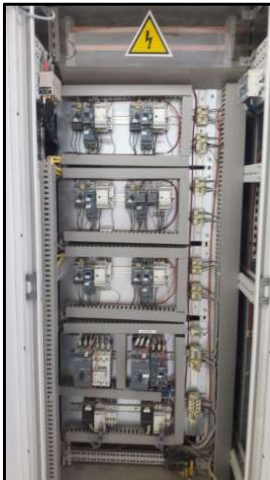
Figura 100. Tablero eléctrico, componentes eléctricos
