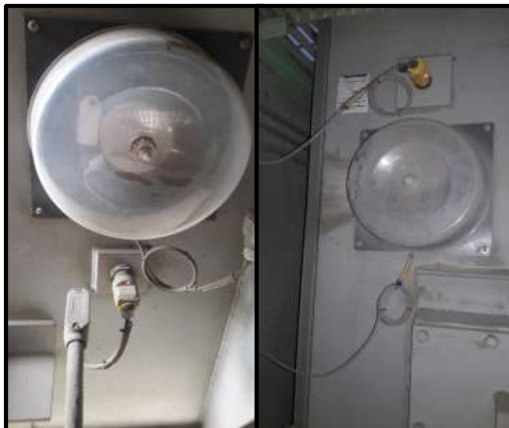
Figura 128. Sensores colocados en la parte externa del elevador cangilones
