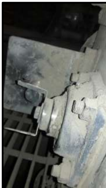
Figura 106. Ubicación del dispositivo de conmutación y termosensible turck
