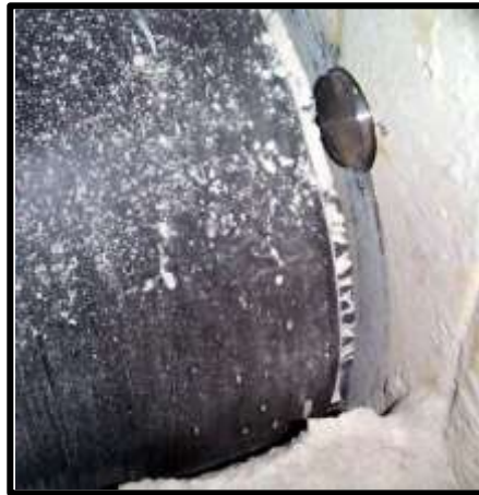
Figura 127. Colocación del sensor inductivo
