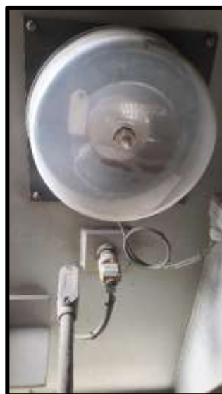
Figura 104. Ubicación del interruptor de proximidad para desvío de banda Kiepel
