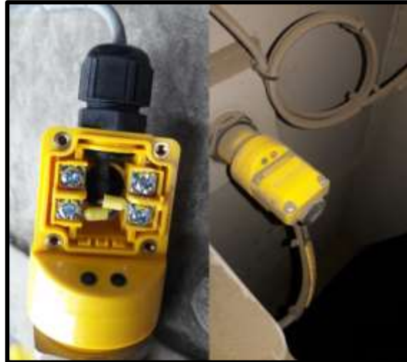
Figura 105. Ubicación del interruptor de proximidad para desvío de banda turck
