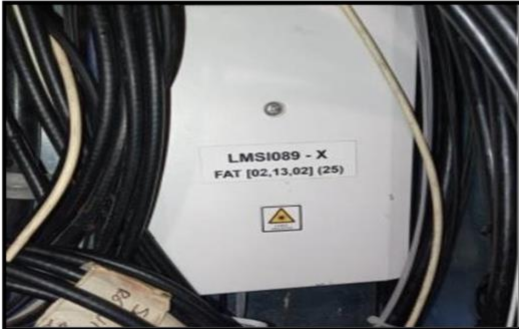
Figura 24 FAT existente ubicada en el 8 piso del cliente
