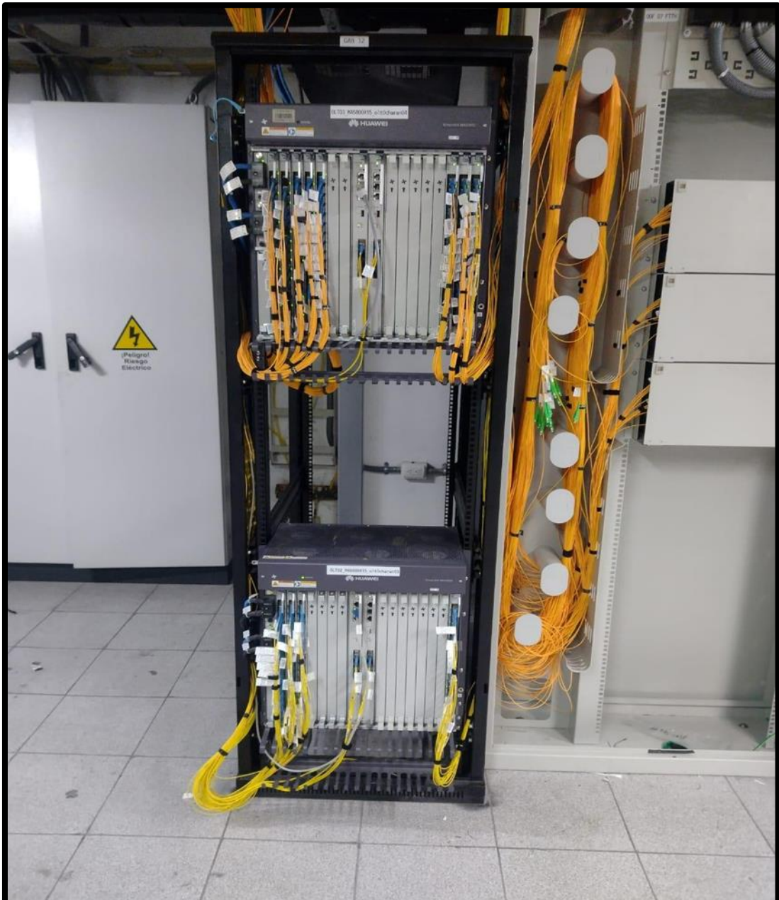
Figura 46 Instalación de equipo OLT
