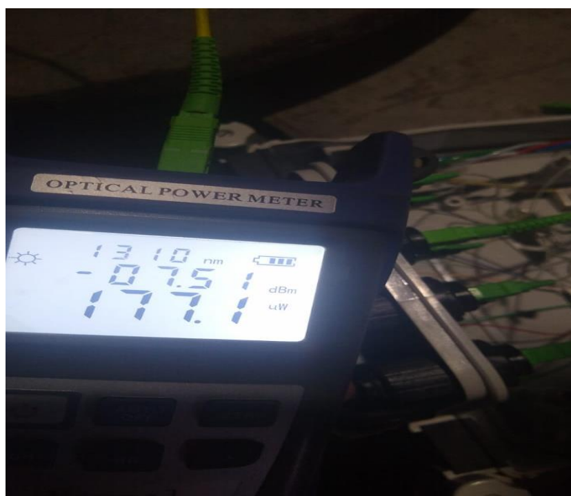
Figura 35. Medida de recepción de potencia de atenuación
