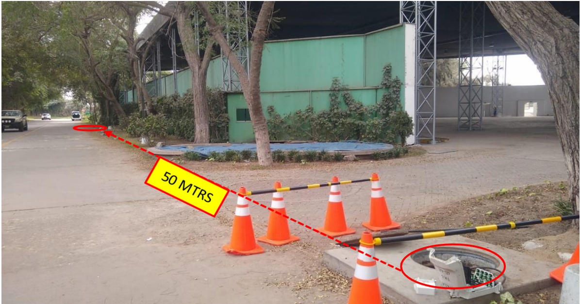
Figura 9. Primer tramo del recorrido de la fibra óptica
