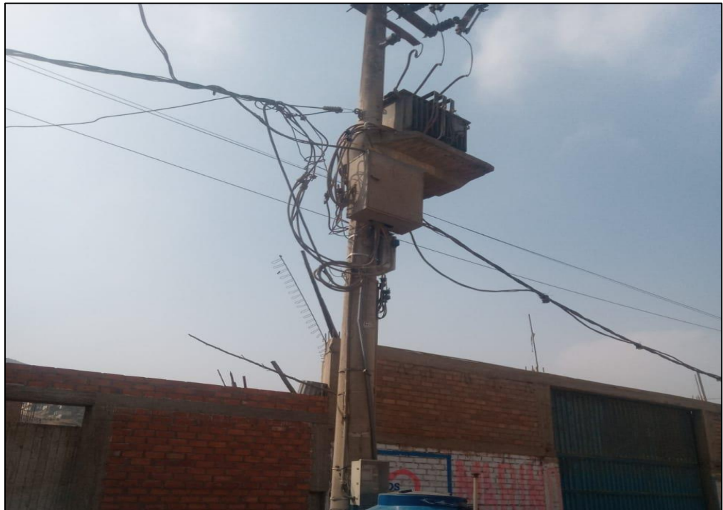
SAM Subestación Aérea Monoposte
