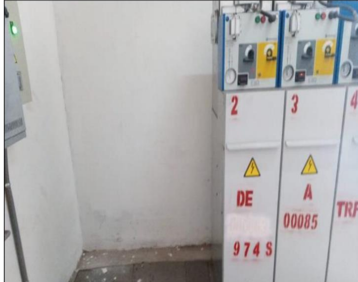
Imagen N°12 Interior de la SED 000885
