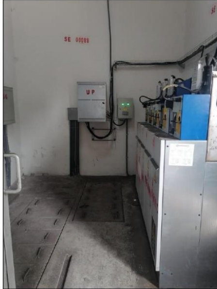
Imagen N°8 Interior de la SED 000885
