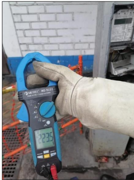
Imagen N°13 Registro de tensión en SED 05174C
