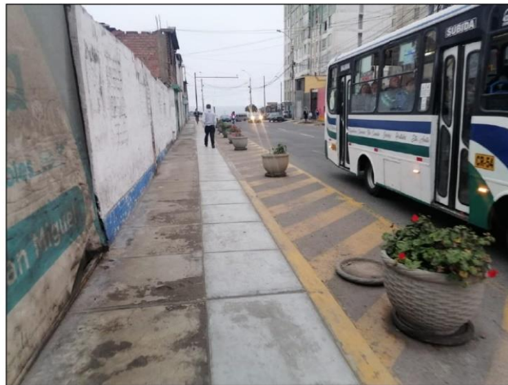
Imagen N°11 Zona de Trabajo
