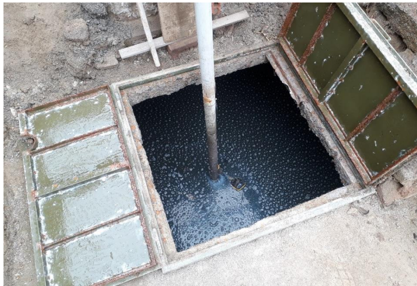
Figura 8. Pozo de sedimentación de la PTAR Manchay Verde
