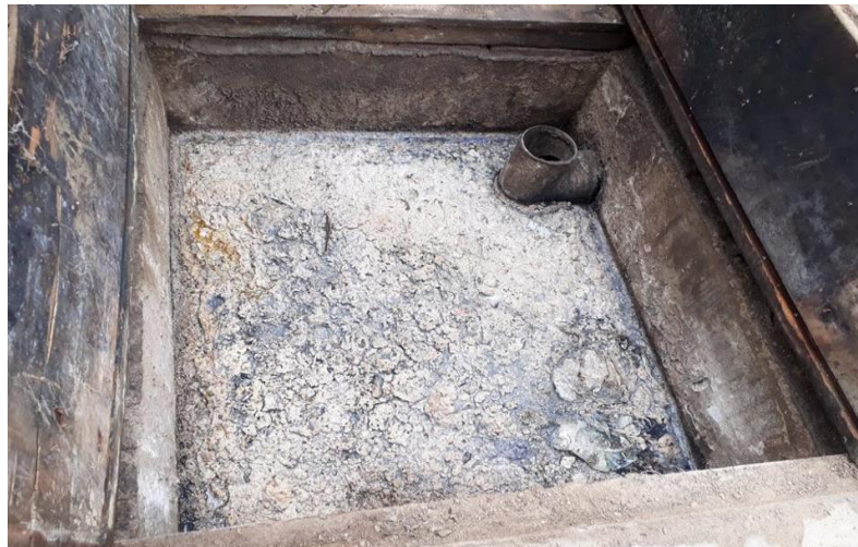
Figura 6. Trampa de grasa instalada en el comedor Juan Pablo II
