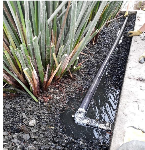
Fotografía 2. Colmatación del lecho filtrante del humedal
