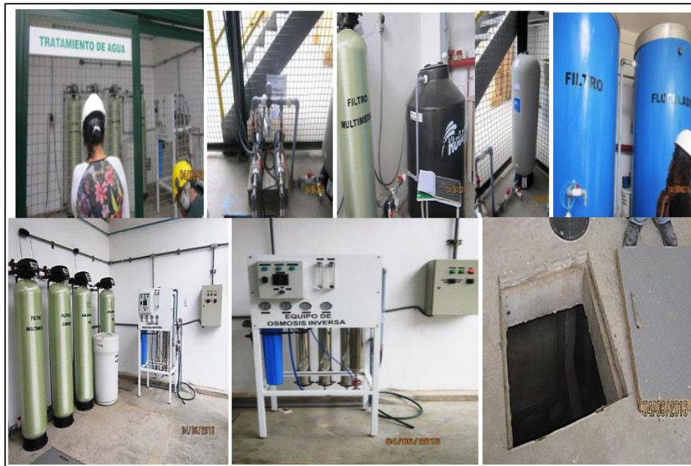
Figura 4 Sistema de Tratamiento de Aguas Residuales y de Ósmosis Inversa
