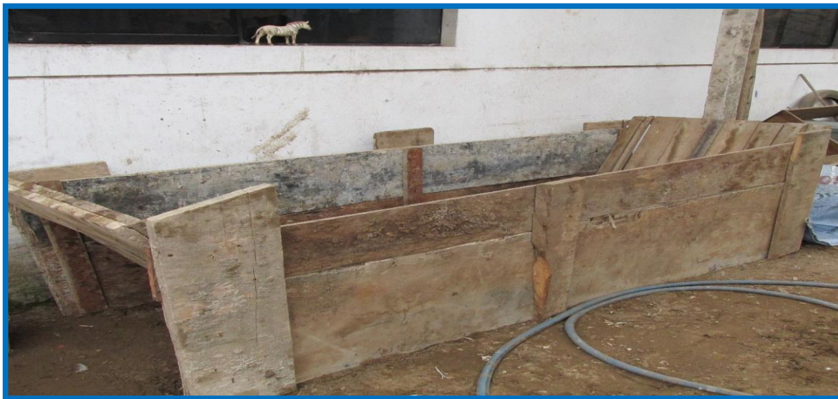
Anexo N°5. Foto del soporte de madera para el biodigestor.
