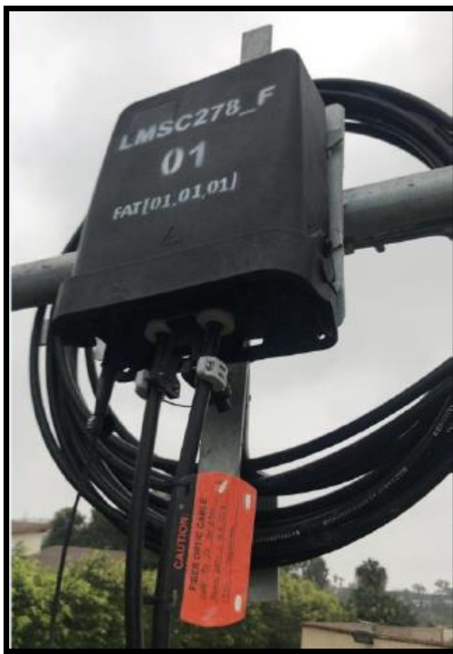
Figura 33. FAT rotulado y etiquetado final.
