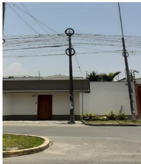
Figura 19: Figura de poste17 (existente) donde muestra reserva de fibra óptica.
