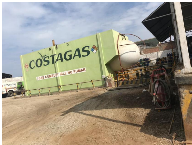
Figura 3. Tanque de almacenamiento de GLP Fuente: Elaboración propia
