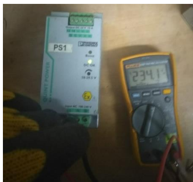
Figura 64. Medición de entrada de la fuente de voltaje Fuente: Elaboración propia
