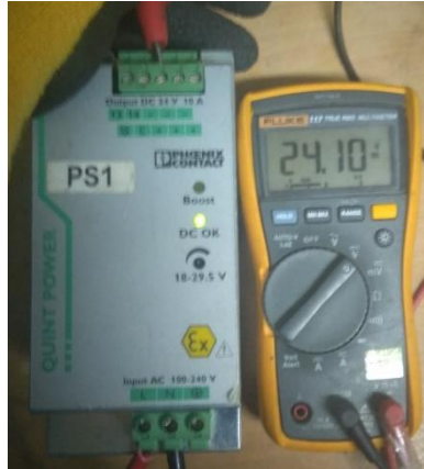
Figura 65. Medición de salida de la fuente de voltaje Fuente: elaboración propia
