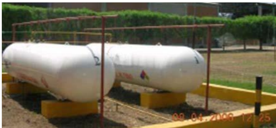
Figura 6. Tanques estacionarios dentro de dique de seguridad Fuente: Charla de Capacitación sobre seguridad en Plantas Envasadoras de GLP, OSINERGMIN (2011)
