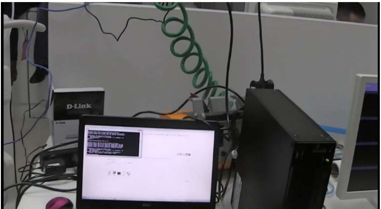
Figura 34. Foto de la configuración de la Central de Monitoreo, realizando ping de la laptop a la Estación Infinity ICS. Fuente: Elaboración propia, 2019
