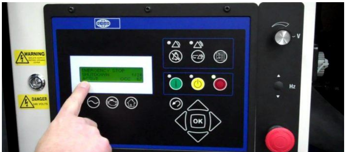
Figura 5: Panel de control de grupo electrógeno
