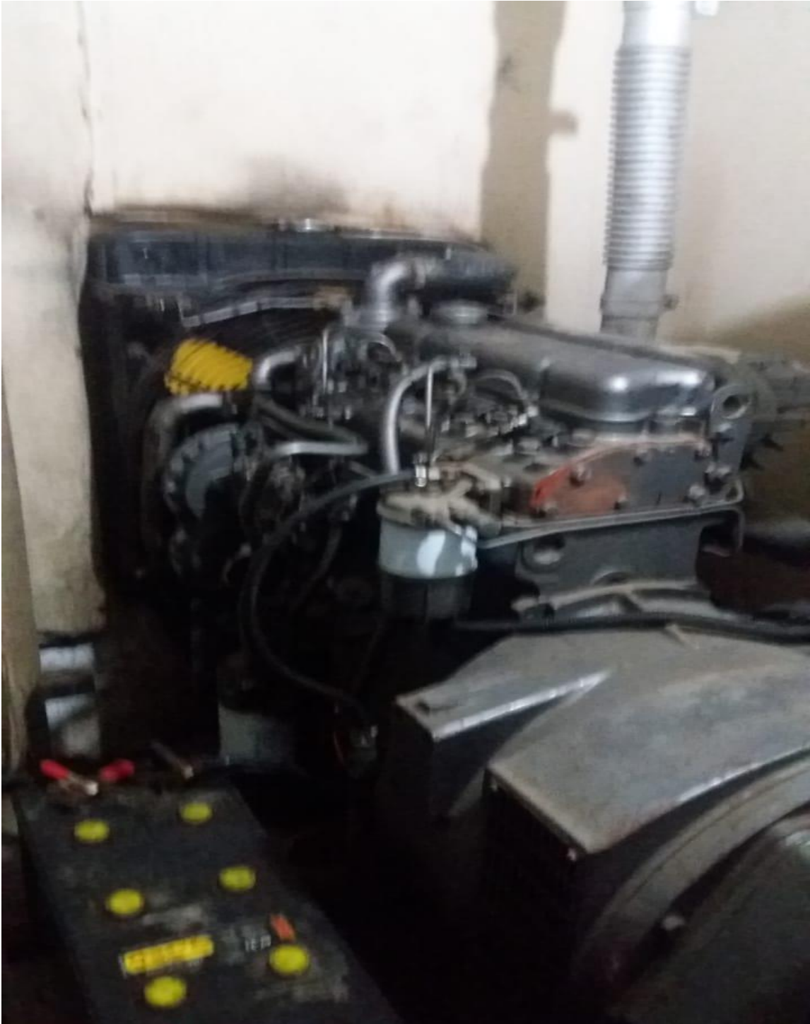
Batería del grupo electrógeno.
