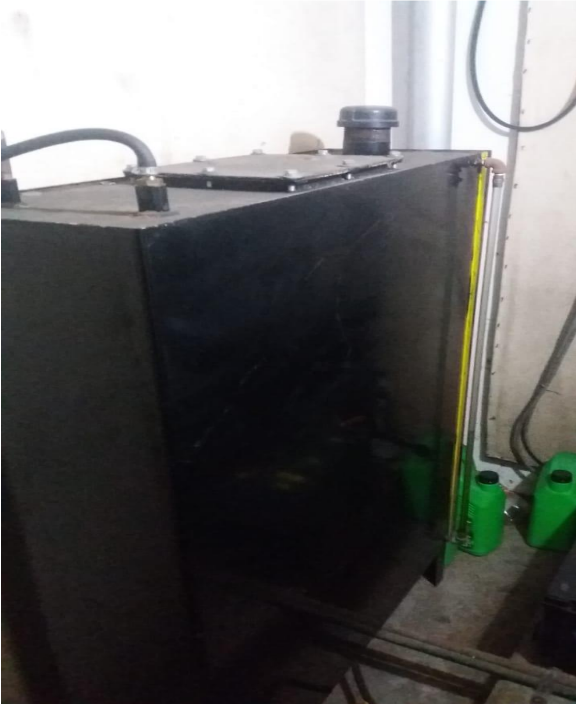
Tanque de combustible.
