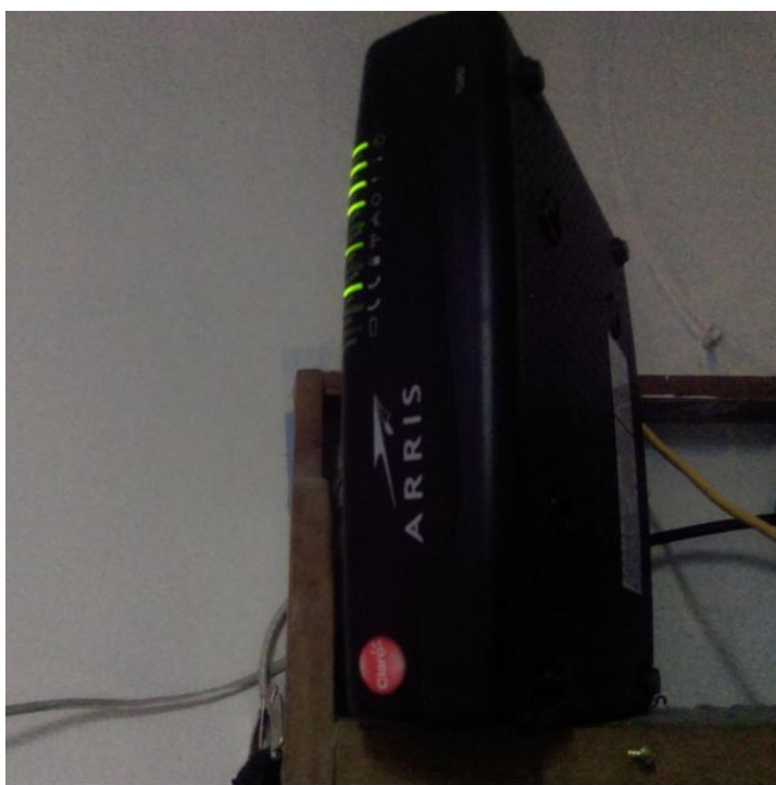
Figura 9: MTA de prueba en casa de abonado de prueba
