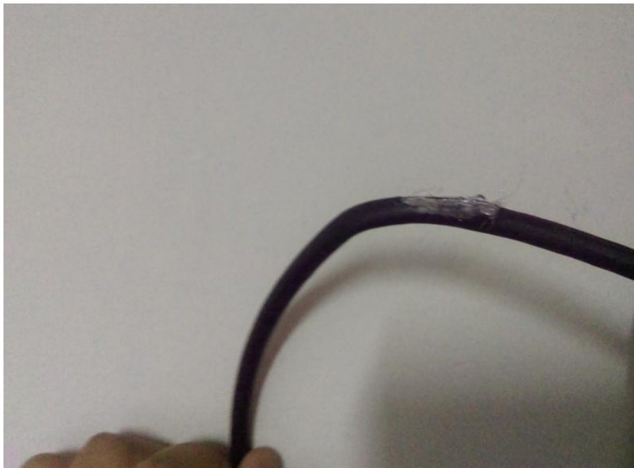
Figura 8: Tramo dañado de cable coaxial
