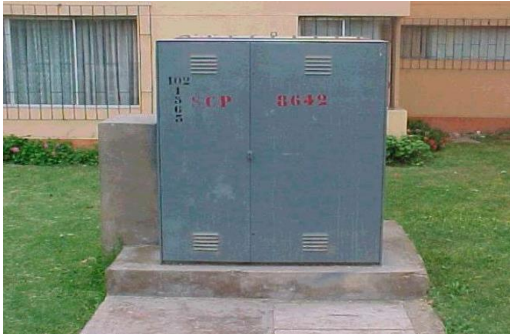
Figura 7 Subestación compacta tipo pedestal
