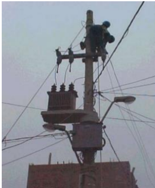
Figura 4 Subestación aérea mono poste
