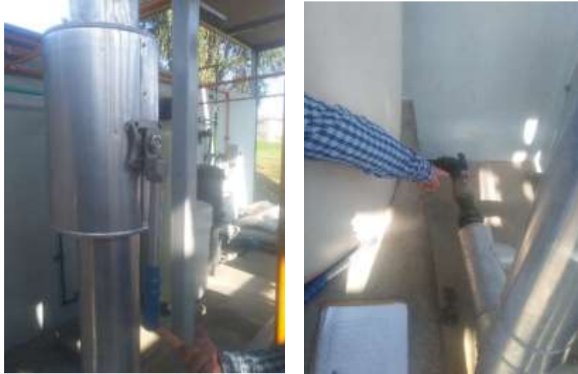
Figura N°3.4. Válvula de retorno de agua y de conexión con tanque pulmón.
