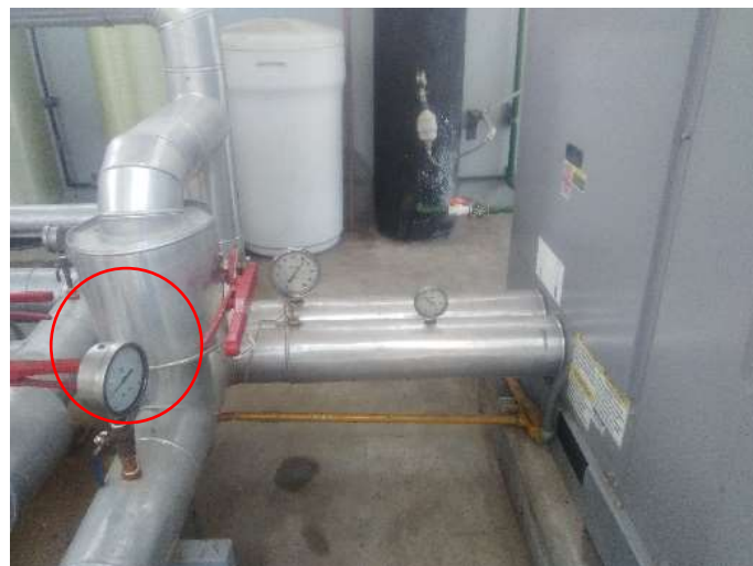
Figura N°3.10. Manómetro de salida del chiller.
