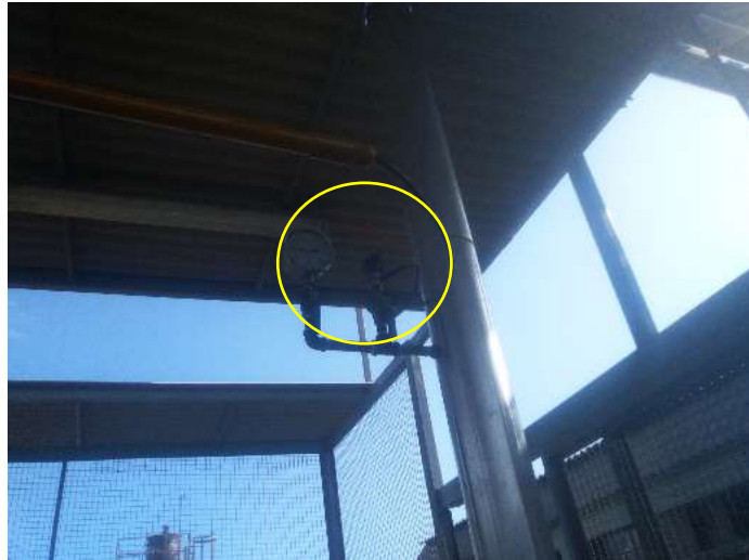
Figura N°3.11. Manómetro de suministro al sistema
