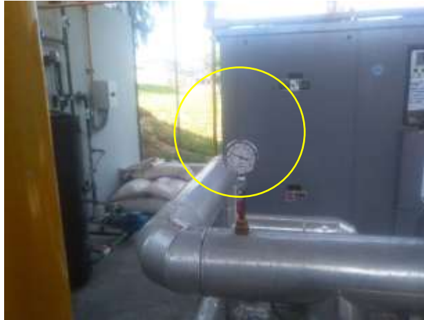
Figura N°3.9. Manómetro de ingreso a chiller.
