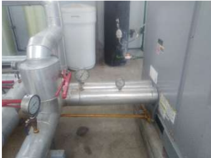
Figura N°3.12. Imagen del by pass entre la tubería de succión y descarga del chiller
