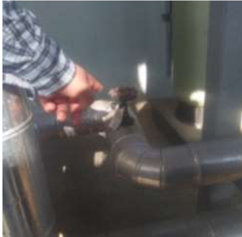
Figura N°3.5. Válvula de conexión entre tanque pulmón y la tubería de descarga del chiller debe encontrarse abierta.
