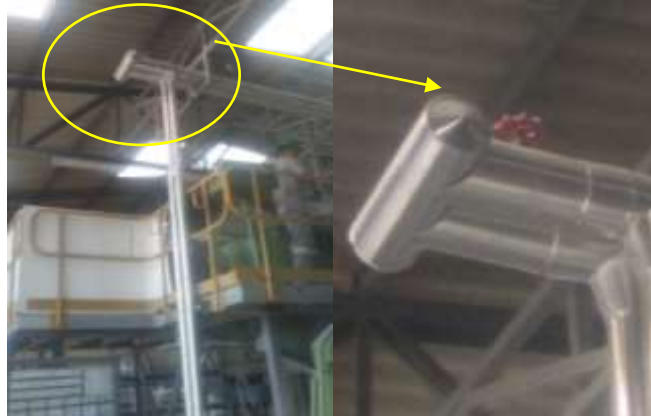
Figura N°3.7. Válvula de regulación de la tubería aérea
