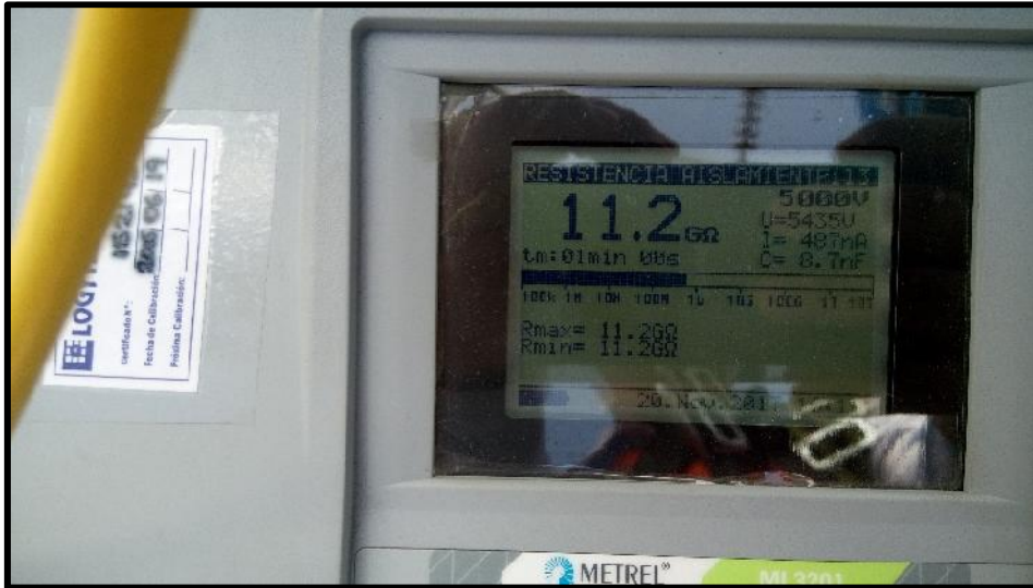
Figura 63 - Resultado de Resistencia de aislamiento de Alta a Tierra
