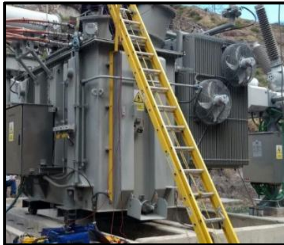
Figura 27 - Transformador de 20MVA con radiadores y ventiladores.
