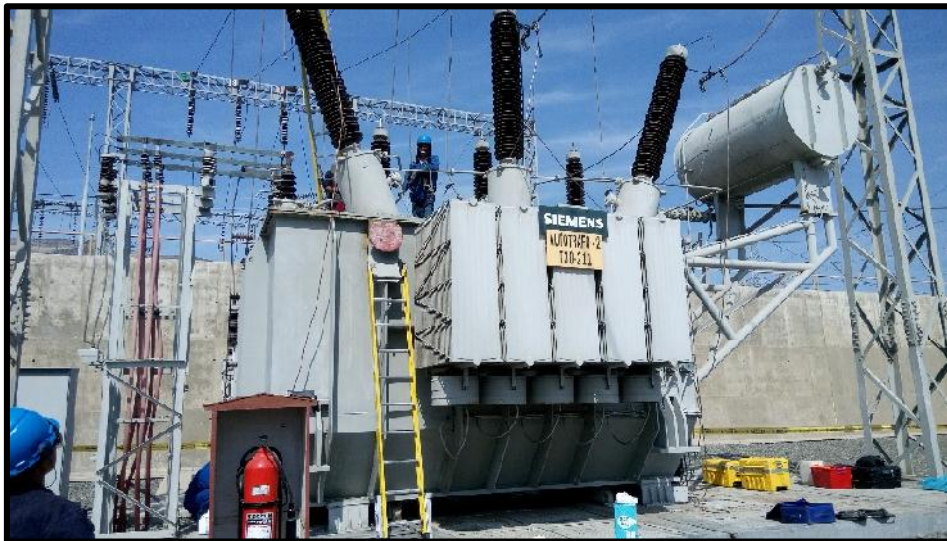
Figura 59 - Autotransformador 100MVA ISA – Transmantaro
