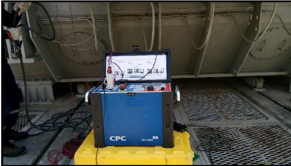
Figura 61 - CPC 100 realizando pruebas al Autotransformador 100MVA ISA – Transmantaro
