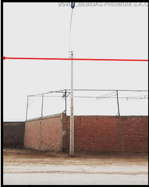
Figura 33: Detalle de poste 14 LDS. en Calle 6
