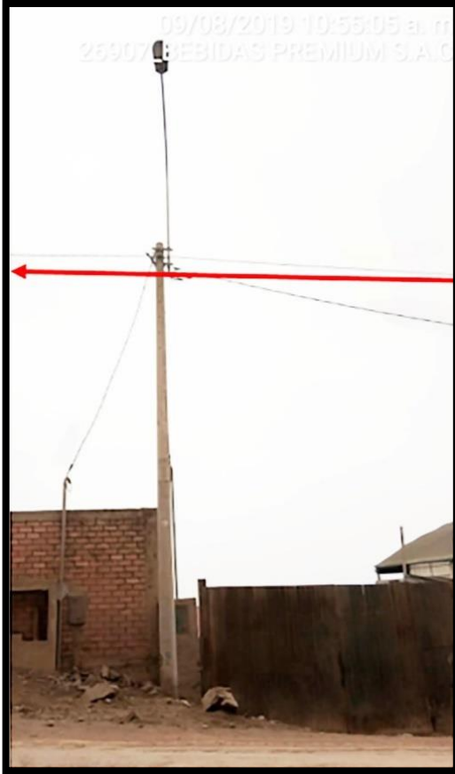
Figura 32: Detalle de poste 13 LDS. en Calle 6
