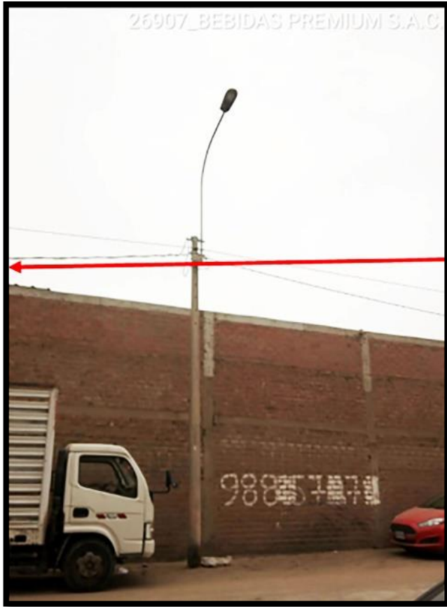
Figura 30: Detalle de poste 11 LDS. en Calle 6
