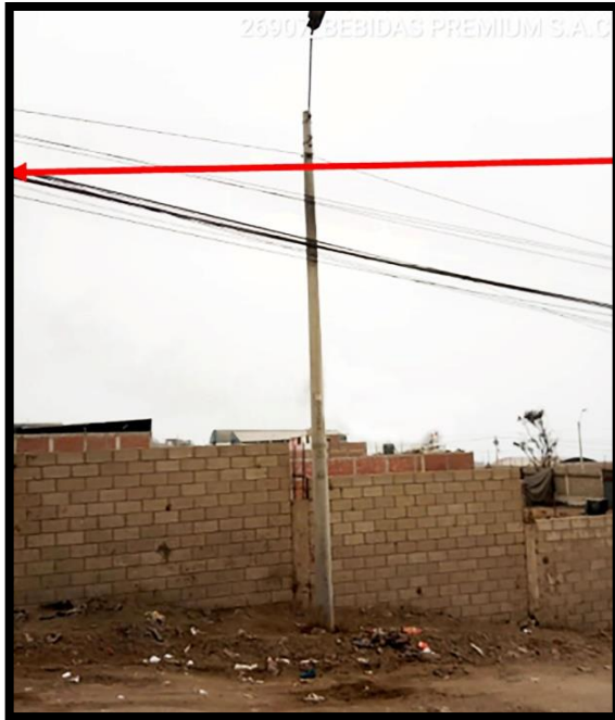
Figura 26: Detalle de poste 07 LDS. en Calle 14
