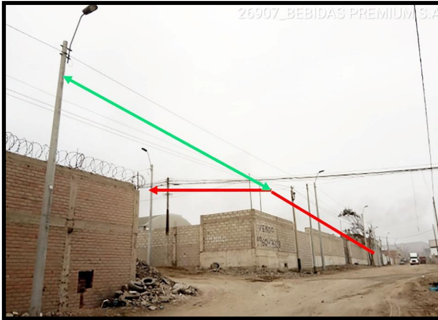
Figura 23: Detalle de Cable mensajero, poste 04 LDS en Calle 5
