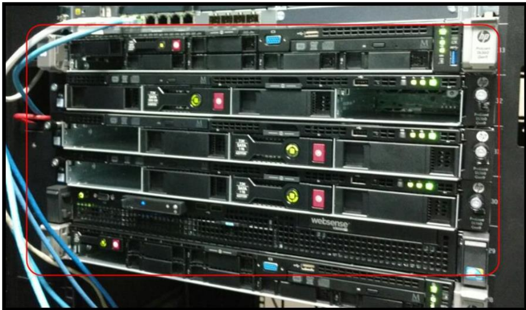
Figura 32: Servidores instalados en la sede principal para la seguridad administrada. Fuente: Reporte de Instalación.
