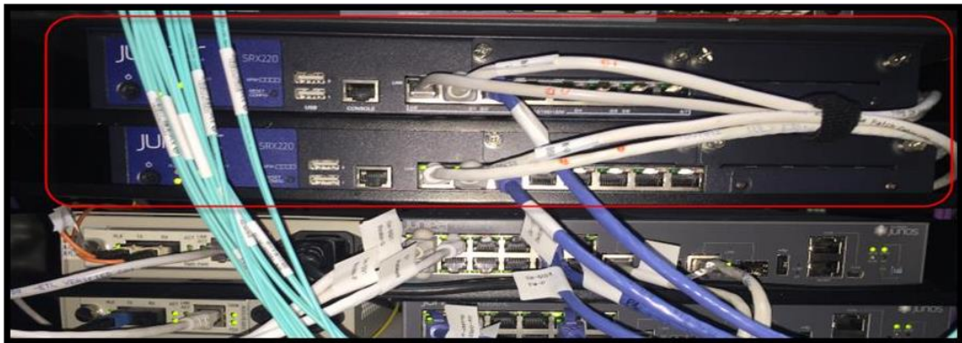
Figura 25: Router SRX220 en clouster instalado en la sede principal Fuente: Reporte de instalación.
