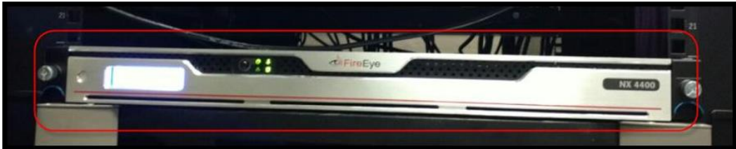
Figura 31: Equipo FIREEYE instalado en la sede principal. Fuente: Reporte de Instalación.
