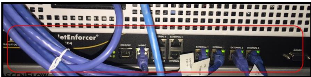
Figura 29: Equipo ALLOT instalado en la sede principal. Fuente: Reporte de Instalación.
