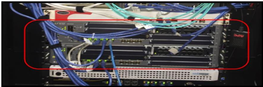
Figura 26: FIREWALL SRX550 en clouster instalado en la sede principal Fuente: Reporte de instalación.
