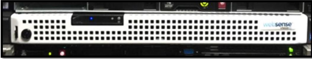
Figura 30: Equipo WEBSSENSE instalado en la sede principal. Fuente: Reporte de Instalación.
