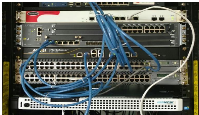
Figura 35: Equipos RADWARE, ALLOT, FIREWALL, SWITCH, WEBSense. Fuente: Reporte de Instalación.
