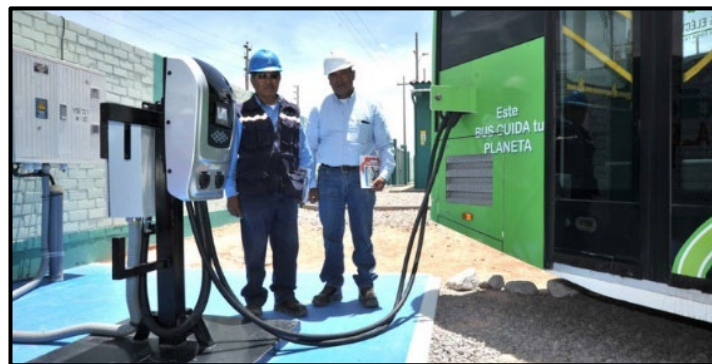
Figura N° 8: Recarga de un bus eléctrico 10
