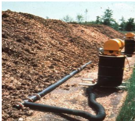
Figura 7. Detalle de pilas estáticas con aireación activa
