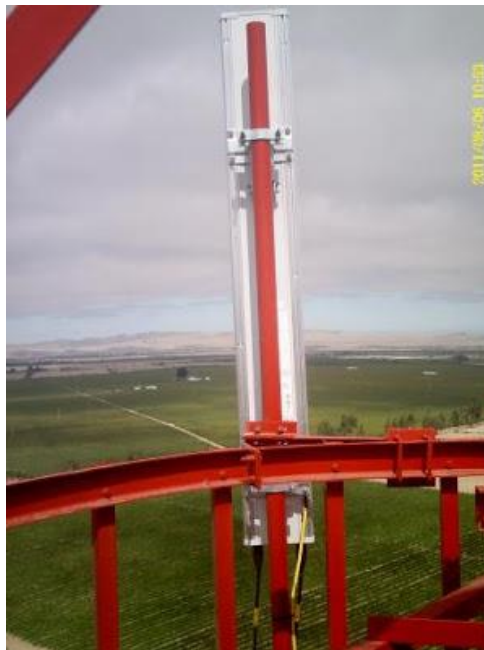
Figura 37: Antena celular - vista trasera.
