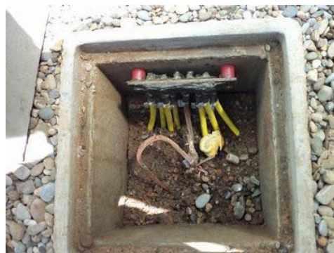
Figura 23: Pozo y barra de tierra.
