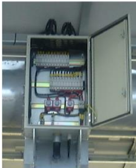
Figura 27: Caja de protección DC, con fusibles y varistores.
