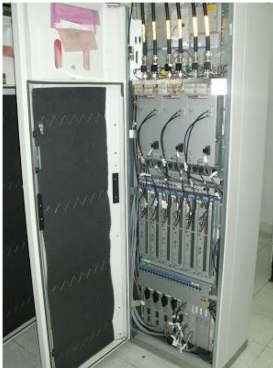
Figura 29: Equipo Radio Base - Ericsson 2206 tipo Indoor.
