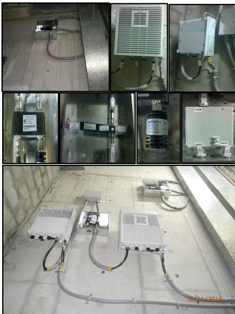
Figura 3-28 Instalación de RRU 3G_4G, Splitter, Coupler, Diplexor y Carga Fuente: Elaboración propia
