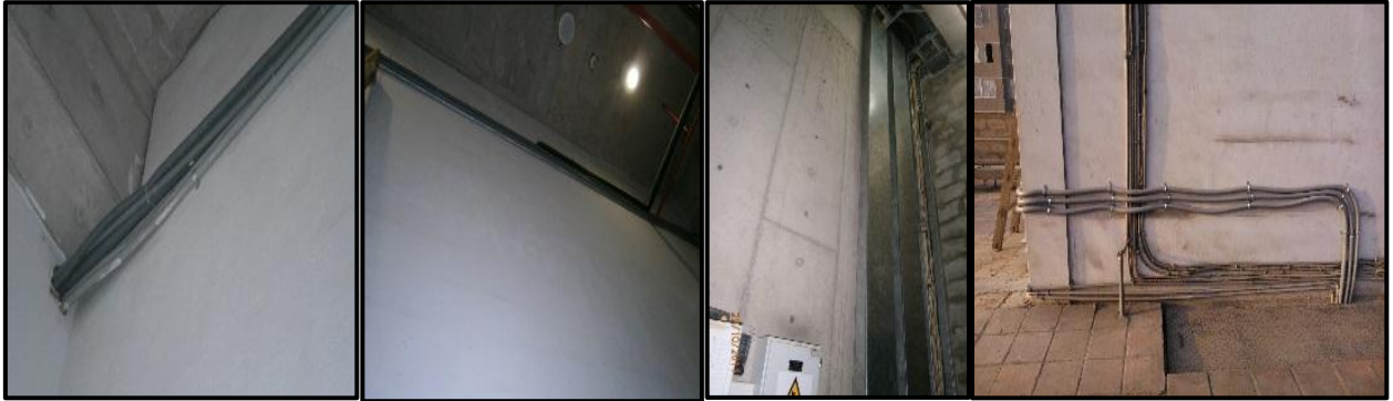
Figura 3-29 Recorrido de la tubería para conectar la RRU con la BBU
