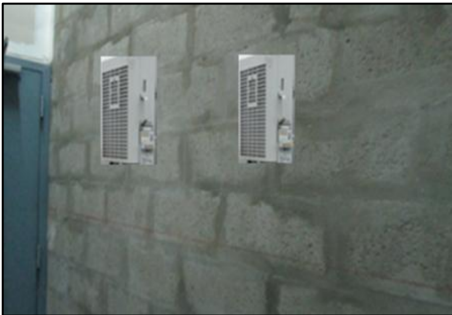
Figura 3-20 Ubicación de RRU - PISO_1 (Cuarto Eléctrico)
