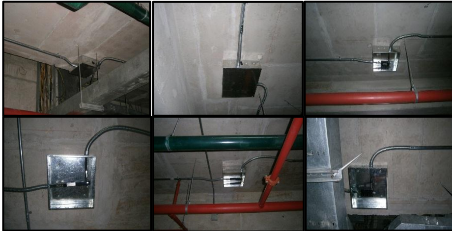
Figura 3-26 Instalación de Splitter y Coupler
