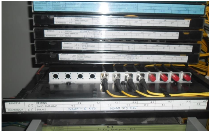
Figura 28. ODF de la central telefónica en San Juan de Miraflores
