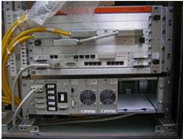
Figura 9. Siemens DSLAM SURPASS hiX 5625
