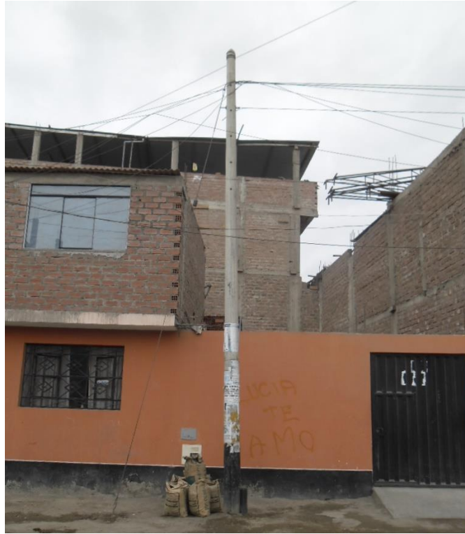
Figura 14. Verificación del estado del poste donde se instalará el DSLAM
