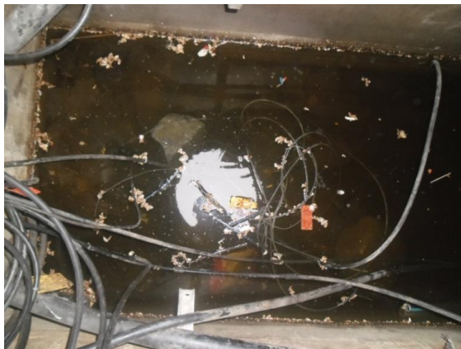
Figura 15. Cámara de registro inundada
