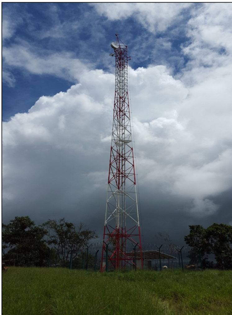
Figura 3.4 – Torre de 23 m.- Ebc_Roque.
