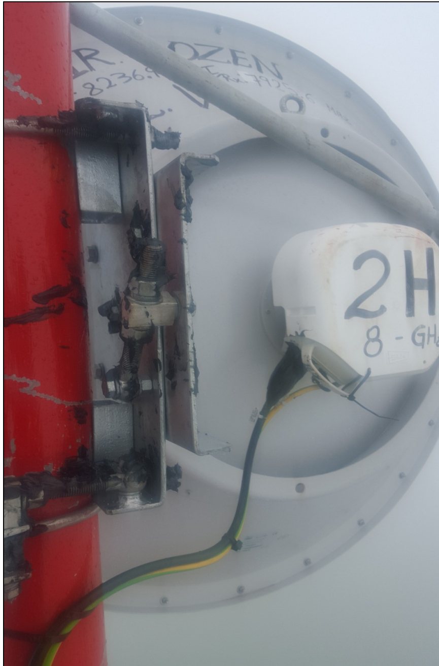
Figura 3.9 – Conexión antena - ODU y Rg-8.
