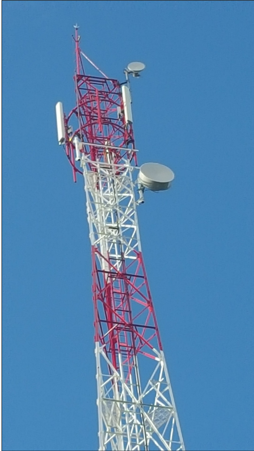
Figura 3.15 – Torre de 40m. - Ebc_Gozen
