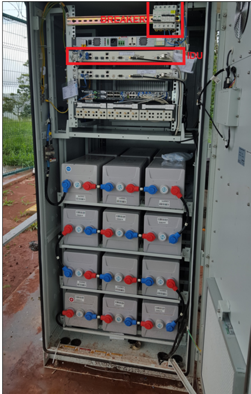
Figura 3.6 – Interior de Gabinete
