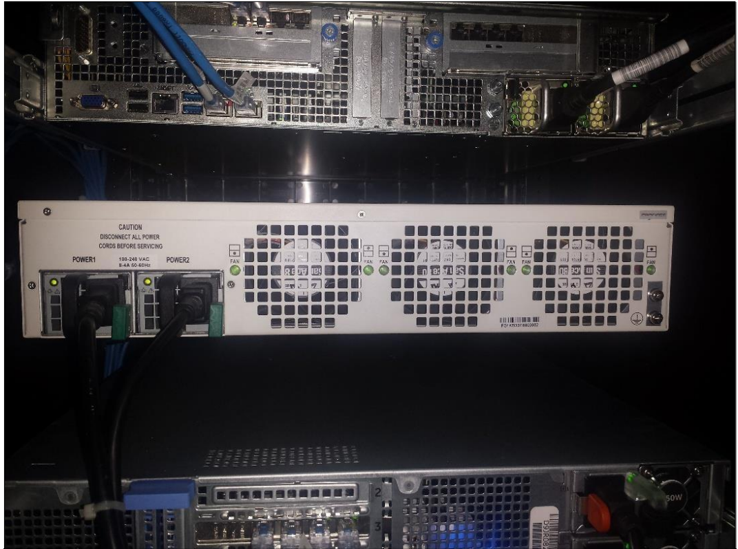
Figura 16: Fuentes de alimentacion del equipo FortiGate
