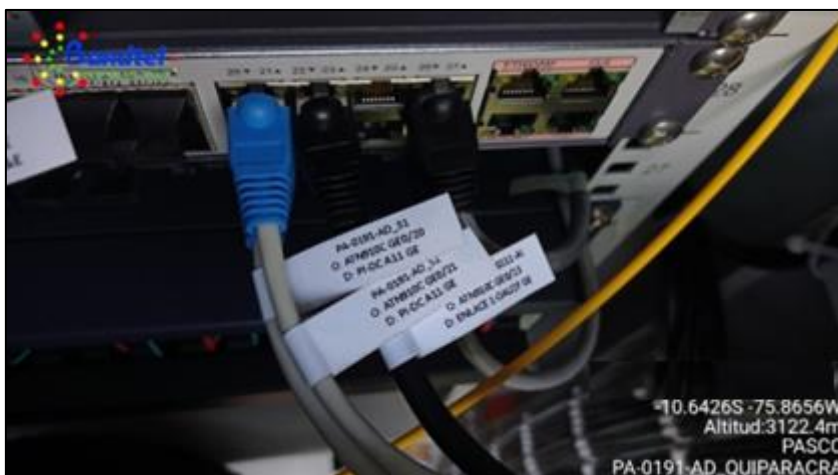
Figura 68. Instalación de datos en el puerto GE0/2/20 Fuente: Elaboración propia
