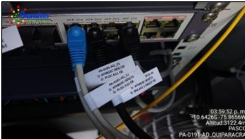
Figura 51. Instalación de datos en el puerto GE0/2/23 Fuente: Elaboración propia
