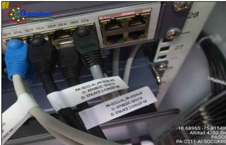
Figura 55. Instalación de datos en el puerto GE0/2/23 Fuente: Elaboración propia
