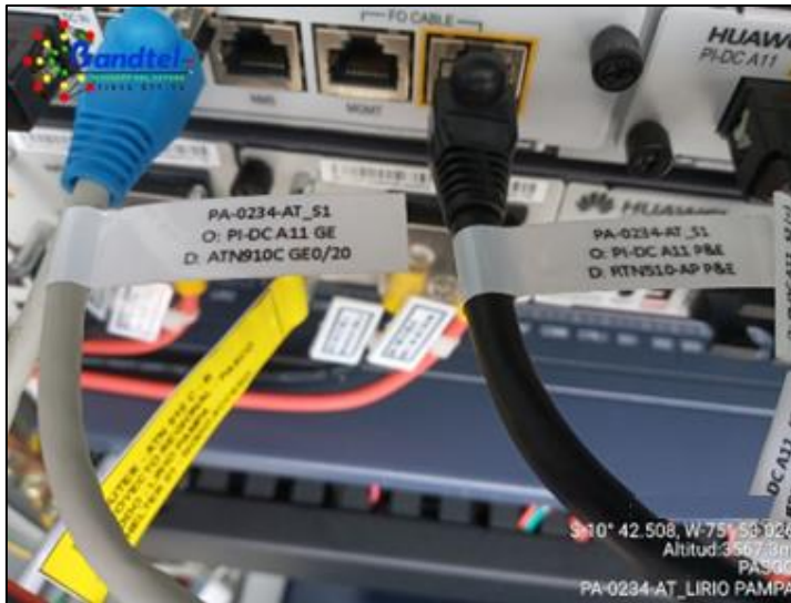
Figura 83. Instalación de datos en el puerto GE0/2/20 Fuente: Elaboración propia
