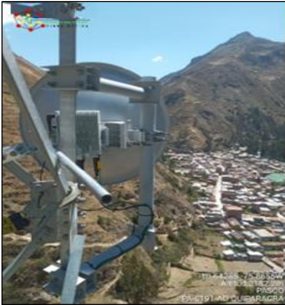
Figura 50. Antena instalada y orientada hacia Socorro Fuente: Elaboración propia
