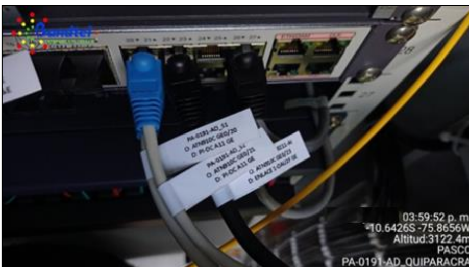
Figura 72. Instalación de datos en el puerto GE0/2/21 Fuente: Elaboración propia
