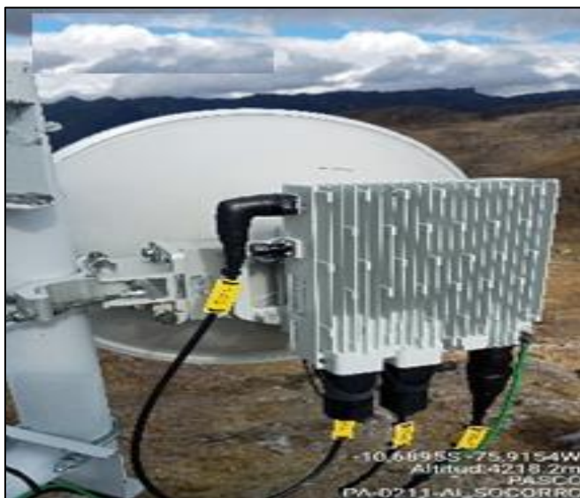
Figura 58. Antena instalada y orientada hacia Lirio Pampa Fuente: Elaboración propia
