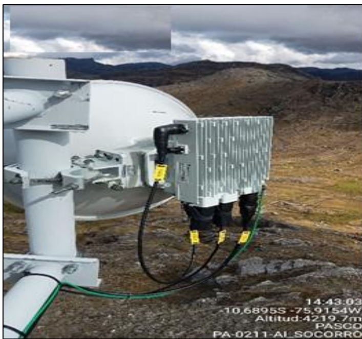
Figura 54. Antena instalada y orientada hacia Quiparacra Fuente: Elaboración propia
