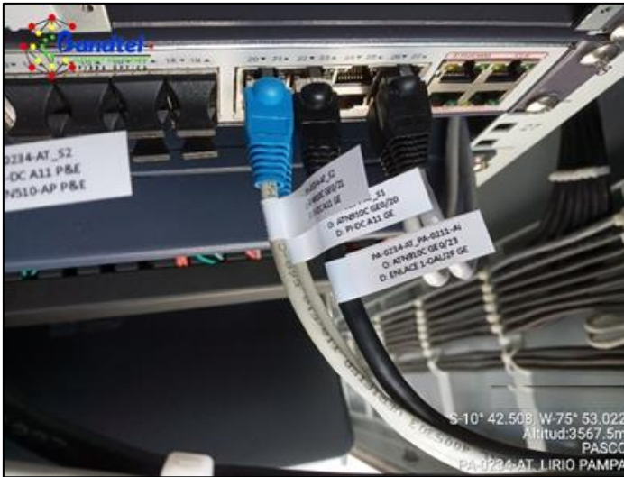
Figura 59. Instalación de datos en el puerto GE0/2/23 Fuente: Elaboración propia
