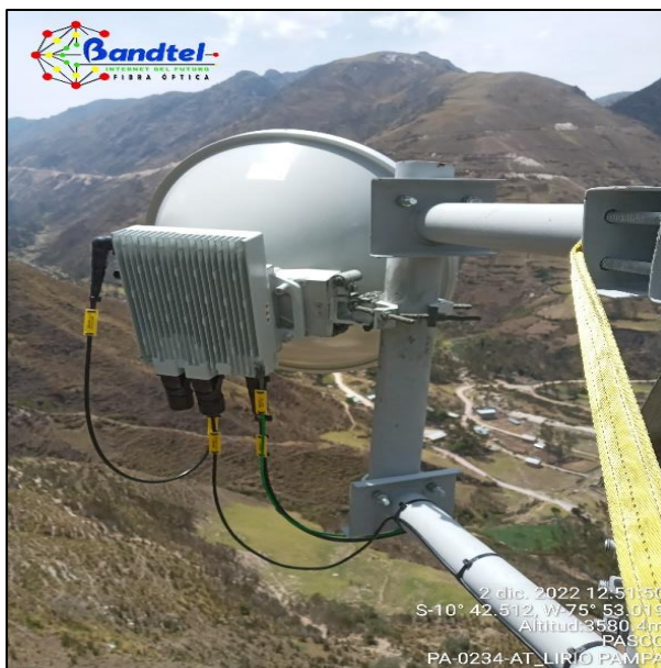
Figura 62. Antena instalada y orientada hacia Socorro Fuente: Elaboración propia
