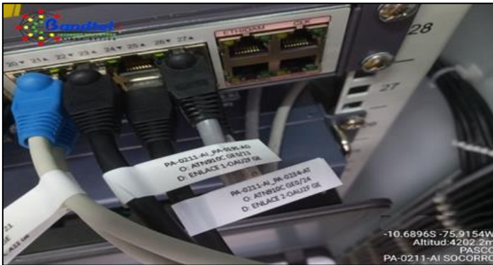
Figura 63. Instalación de datos en el puerto GE0/2/24 Fuente: Elaboración propia
