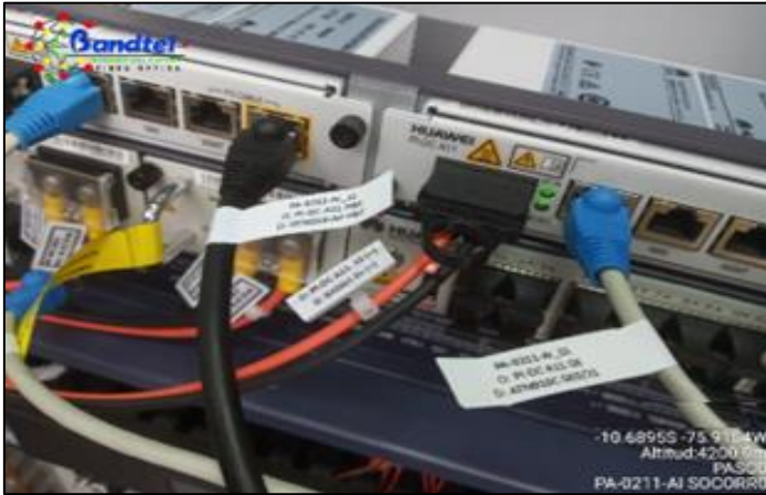
Figura 76. Instalación de datos en el puerto GE0/2/21 Fuente: Elaboración propia
