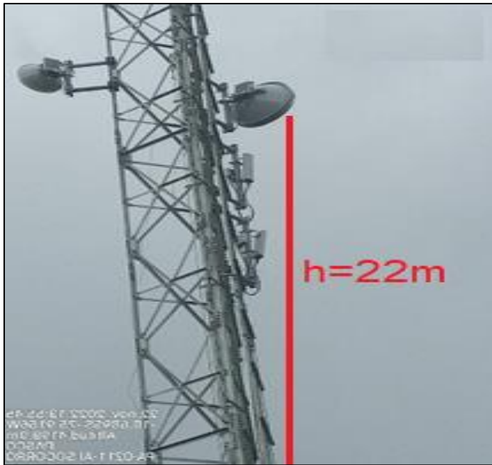
Figura 53. Altura de antena instalada Fuente: Elaboración propia
