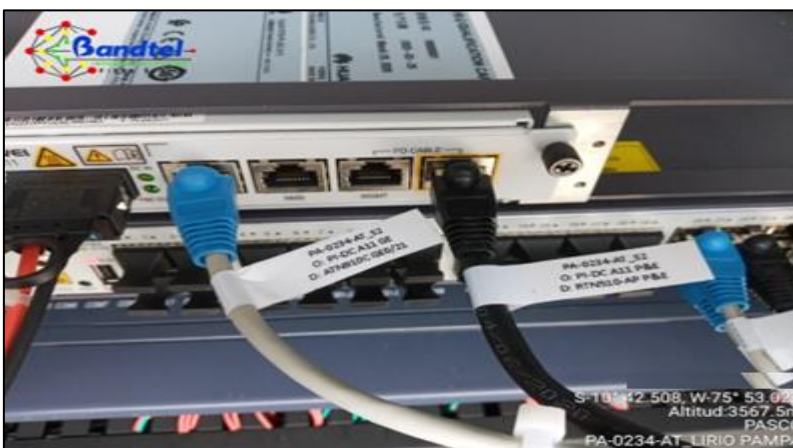
Figura 87. Instalación de datos en el puerto GE0/2/21 Fuente: Elaboración propia
