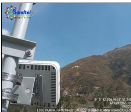
Figura 85. Instalación de IAO PA-0210-IE01
