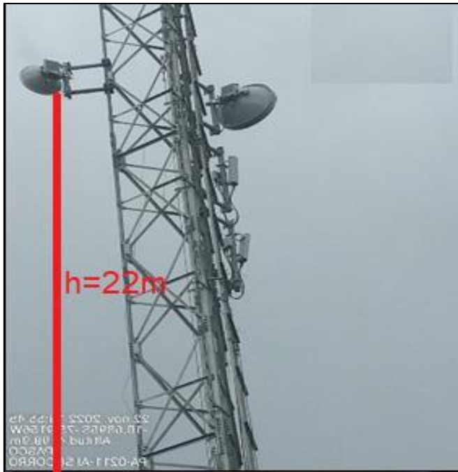
Figura 57. Altura de antena instalada Fuente: Elaboración propia
