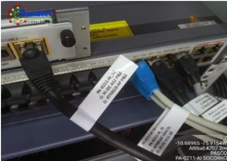
Figura 79. Instalación de datos en el puerto GE0/2/21 Fuente: Elaboración propia
