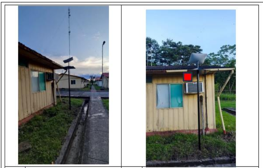
Figura 43 Terminal remoto instalado en el cliente Pluspetrol.
