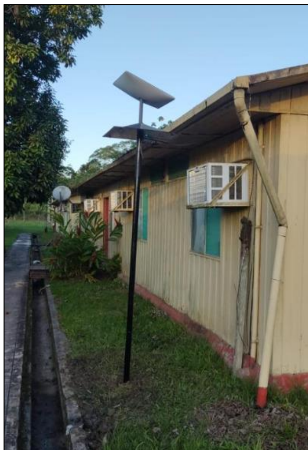
Figura 27 Mástil y terminal remoto Starlink instalado.
