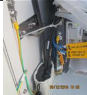
Aterramiento de la IDU
