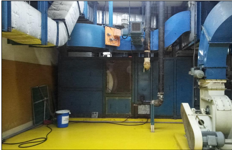
Figura 10.- Equipo N° 7 del sistema de ventilación. Fuente: Registro fotográfico del Autor.
