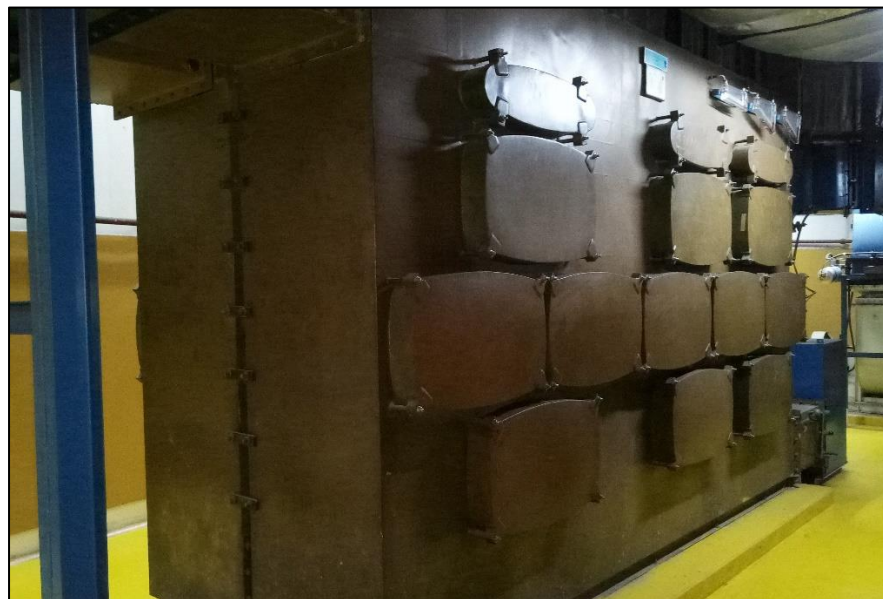
Figura 4.- Banco de filtros del sistema de ventilación Fuente: Registro fotográfico del Autor.
