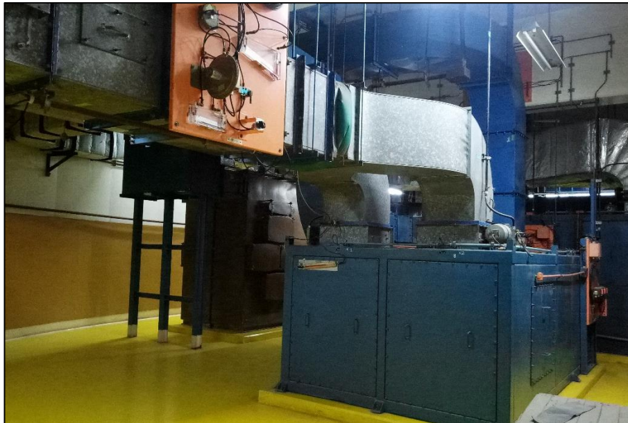
Figura 8.- Equipo N° 8 del sistema de ventilación. Fuente: Registro fotográfico del Autor.
