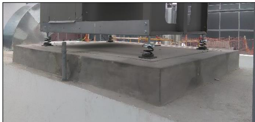
Figura 12 – Base de concreto para equipos en Azotea
