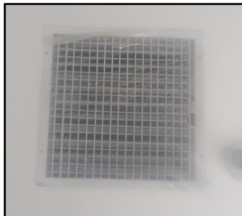
Rejillas de Presurización de Escaleras
