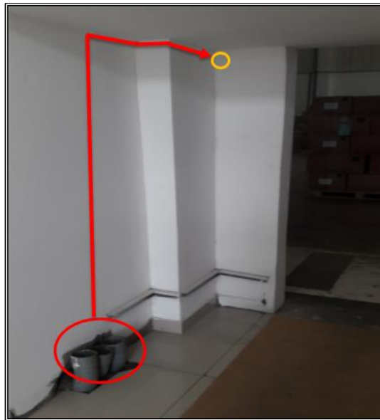
Figura N° 3.25 “Fibra óptica recorre por interior de Teoma Corp” Fuente: Elaboración propia.
