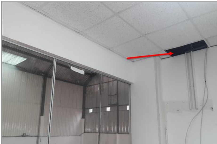
Figura N° 3.28 “Fibra óptica recorre sobre falso techo” Fuente: Elaboración propia.
