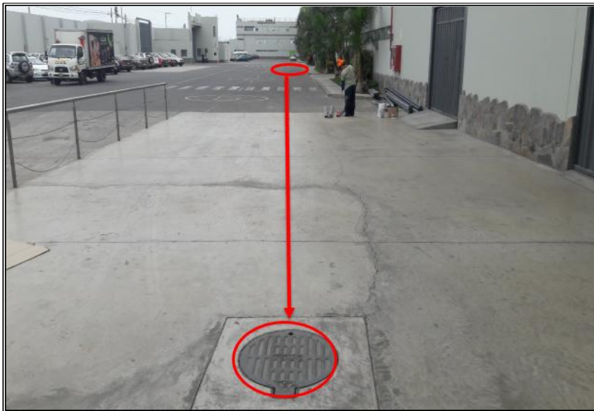
Figura N° 3.23 "Fibra óptica recorre por ductos y buzones existente" Fuente: Elaboración propia.
