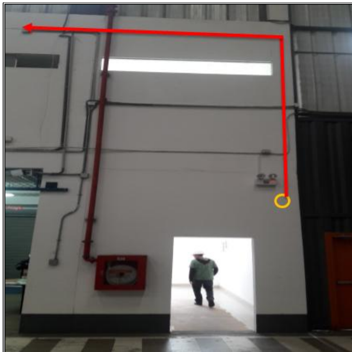
Figura N° 3.26 “Fibra óptica recorre interior de Teoma Corp SAC” Fuente: Elaboración propia.
