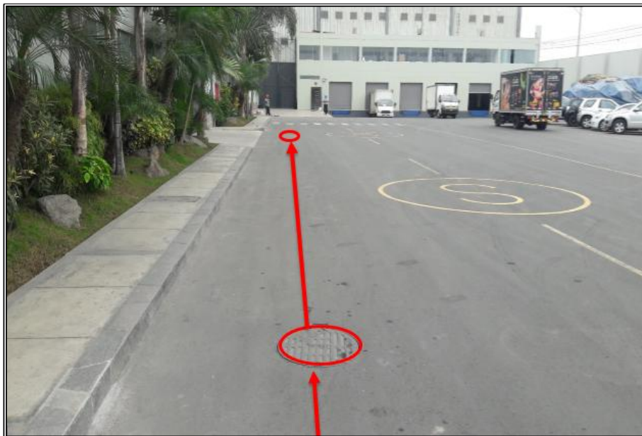
Figura N° 3.22 "Fibra óptica recorre por ductos y buzones existente" Fuente: Elaboración propia.
