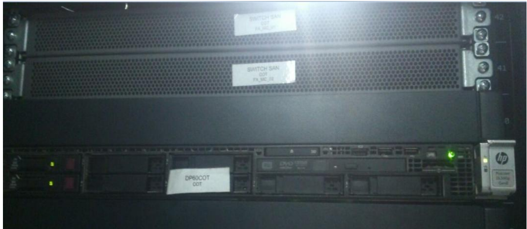
Figura 27. Instalación de Storageworks 8/24 SAN switch. Fuente: Área de Infraestructura GMD.
