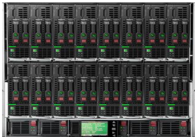
Figura 17. Chasis Blade. Fuente: Data center de GMD.
