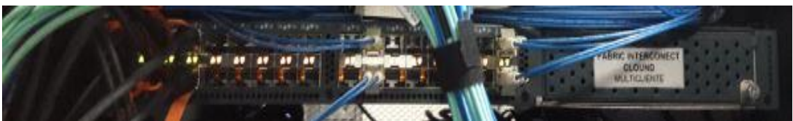
Figura 26. Instalación de switch HP SN6000B FC Fuente: Área de Infraestructura GMD.
