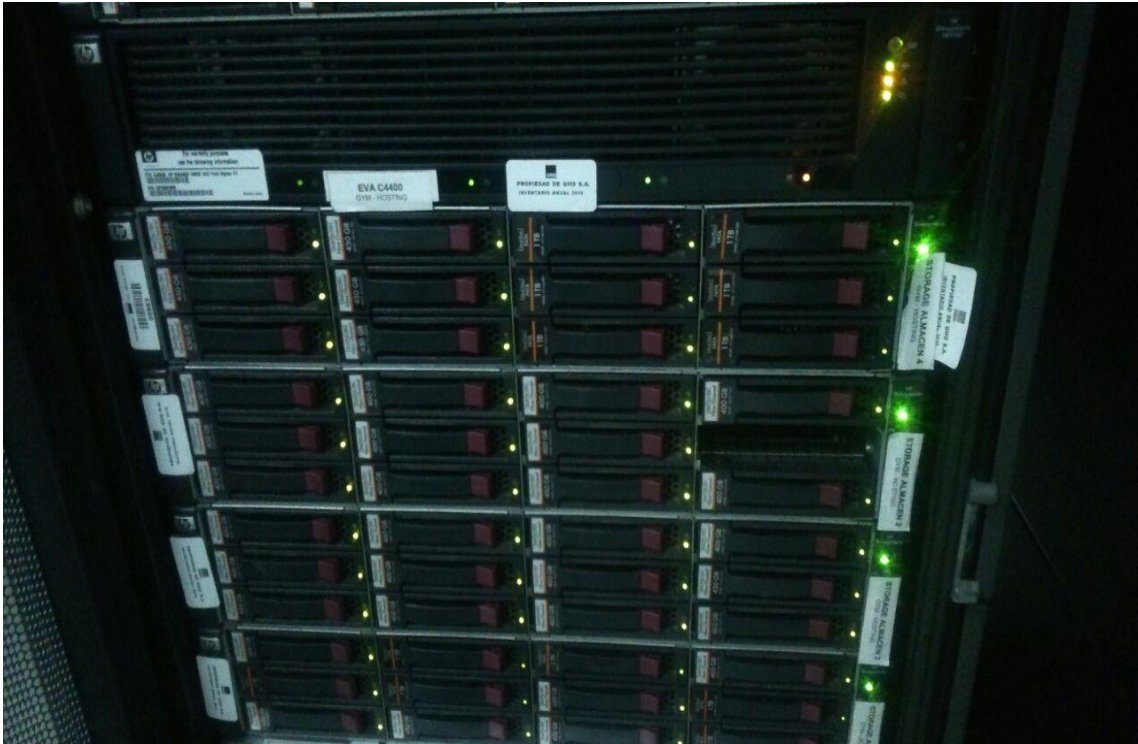
Figura 25. Instalación del almacenamiento EVA en GMD. Fuente: Área de Infraestructura GMD.
