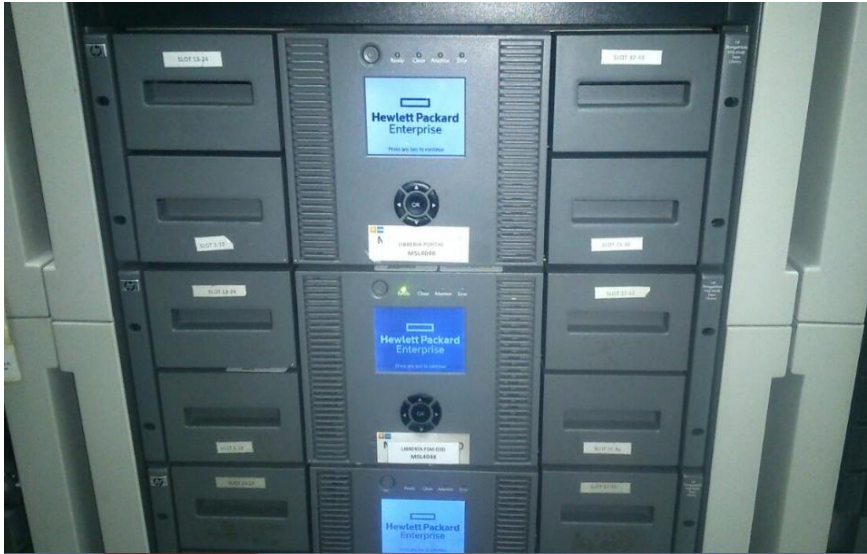
Figura 23. Instalación de librería HP 4048 en GMD. Fuente: Área de Infraestructura.
