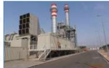
Chimeneas de los Ciclos Simple y Combinado
