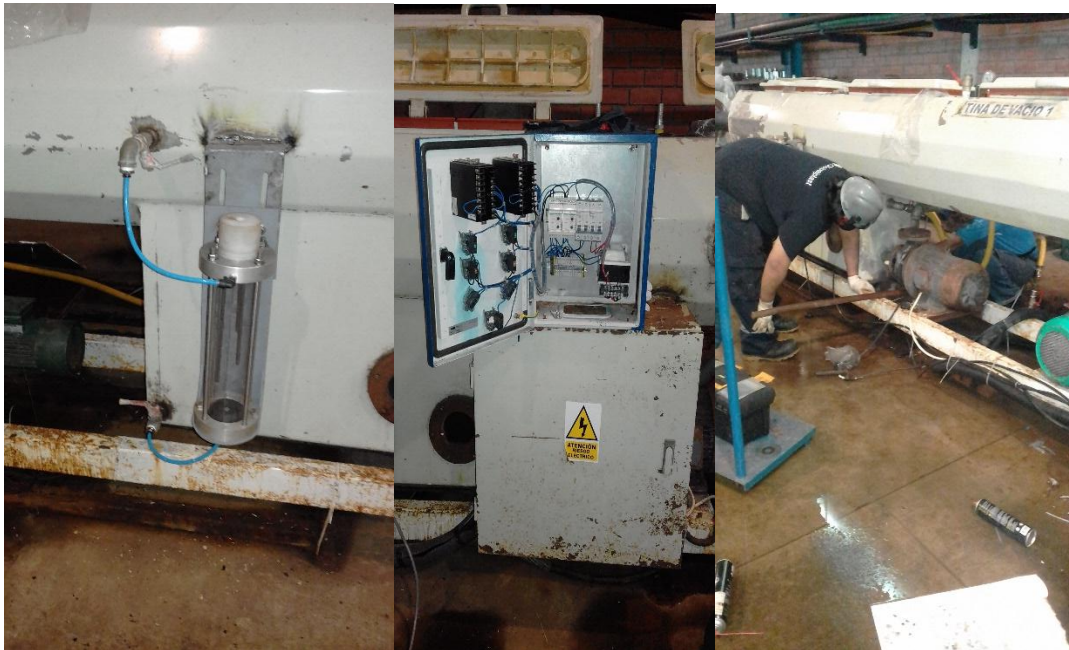
Implementando sistema automático nivel de agua
