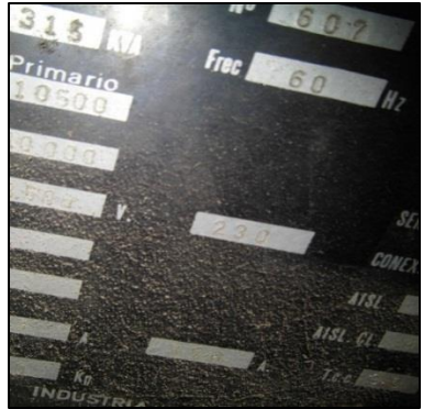
Figura N°14: Placa característica del transformador SE N°3 Fuente: Empresa E&A Automatas
