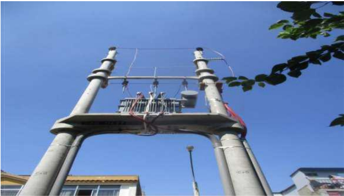
Figura 18: Instalación de transformador de 250kva
