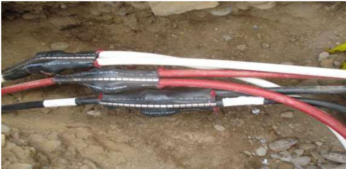
Figura 20: Empalmes de BT Nota: elaboración propia.
