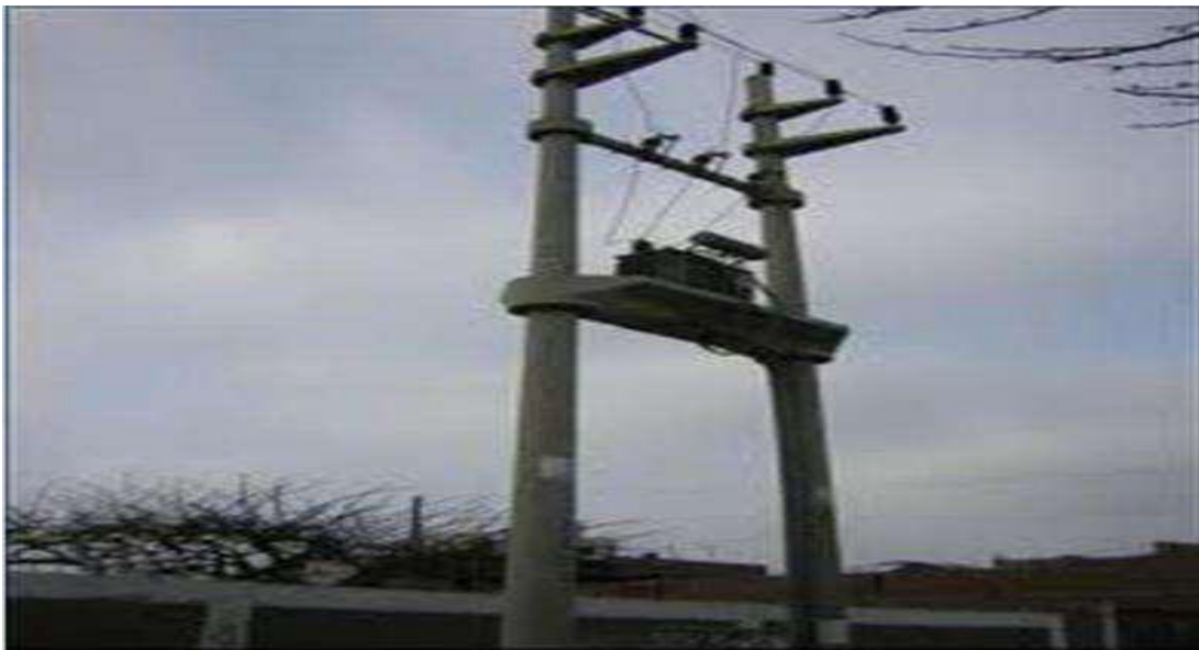
Figura 9. Subestación Aérea Biposte(SAB) Nota: recuperado de http://www.fabinco.com.pe/5.html
