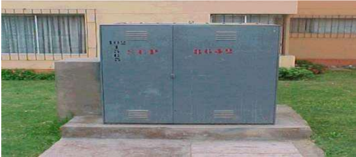
Figura 11. Subestación compacta pedestal (SCP)
