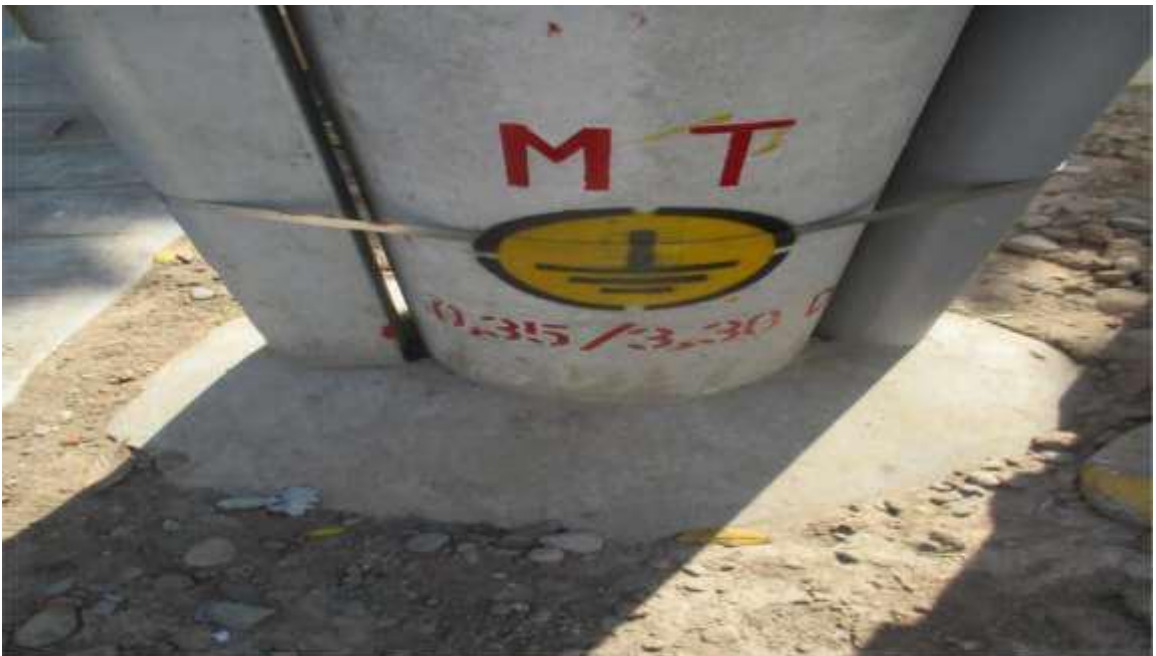
Figura 22: Rotulación de puesta a tierra Fuente: Elaboración propias.
