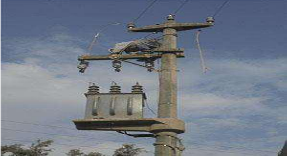
Figura 8. Subestación Aérea Monoposte(SAM) Nota: recuperado de http://yomijocontratistas.com/
