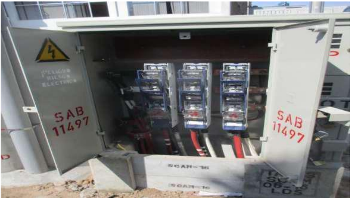
Figura 16: Equipamiento de tablero TAM 4 BT Nota: elaboración propia. .
