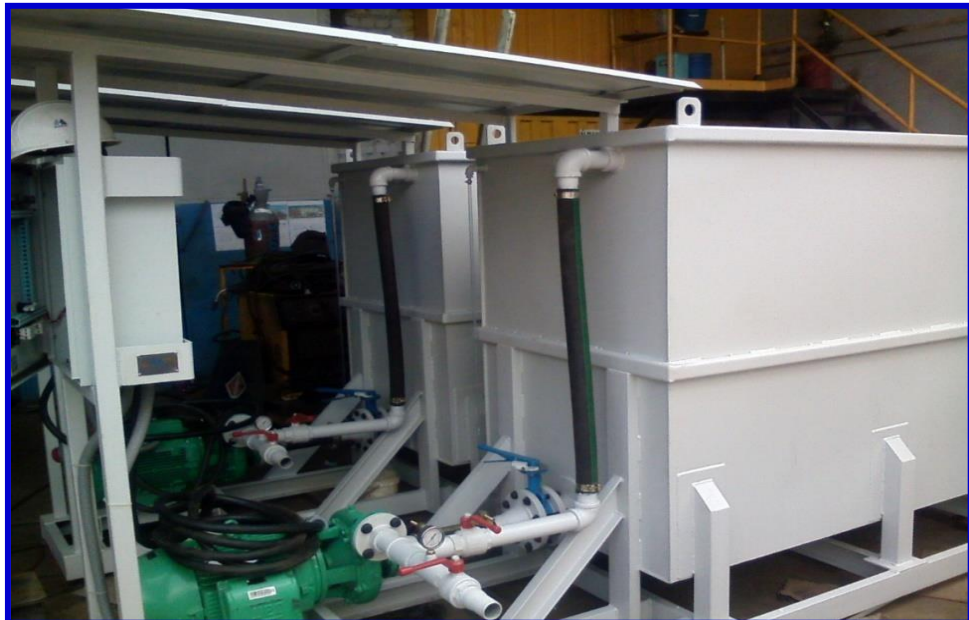
FIGURA N° 45: CONEXIÓN DE LA MANGUERA CON LA BOMBA CENTRIFUGA
