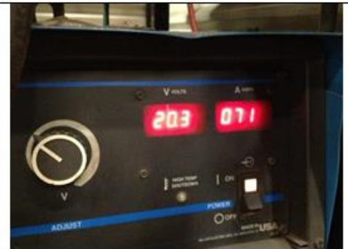
Foto 6. Ajustes del voltaje de la fuente de energía
