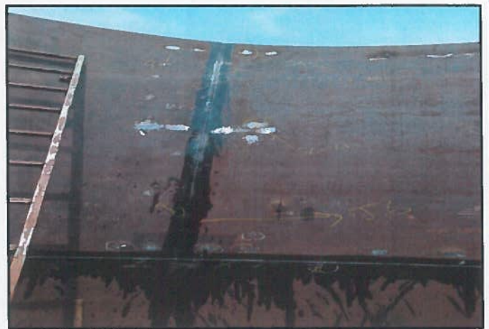
Fotografía N°3: Se observa la cara interior de las juntas soldadas a tope J8 y J6, sobre las cuales se aplicó en toda su extensión aceite SAE 10W30 a una temperatura aproximada de 90°C.
