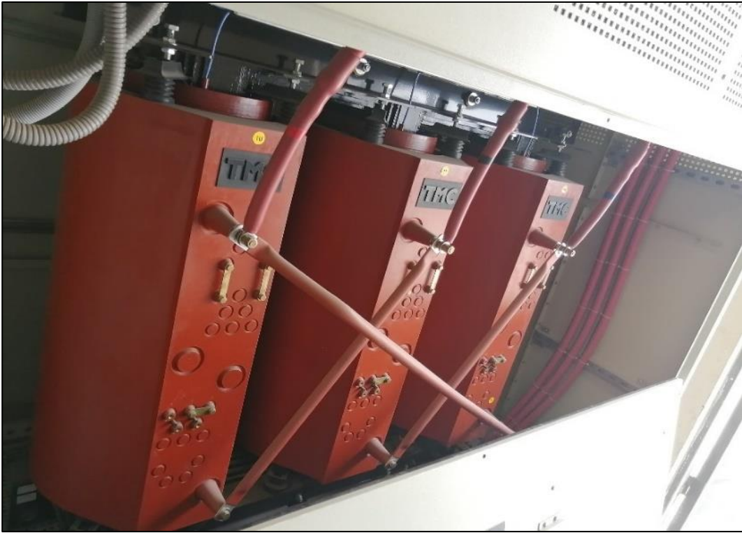
Figura 40: Vista de los Trafos en seco. Fuente: (Propia).
