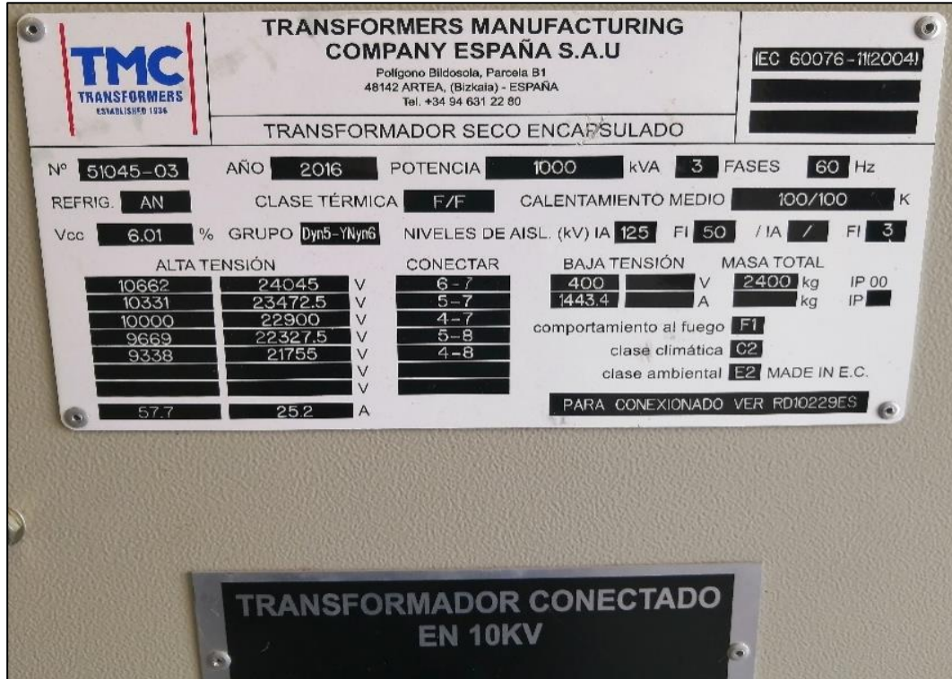
Figura 38: Datos de placa de Transformador. Fuente: (Propia).
