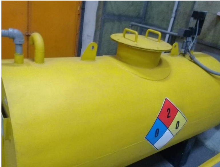
Figura 39: Tanque diario del grupo electrógeno 1 y 2
