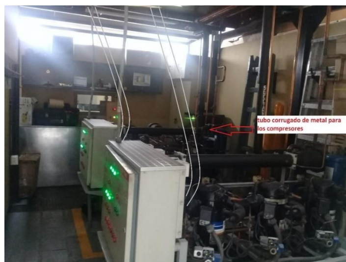
Figura 27: canalizado de los compresores.
