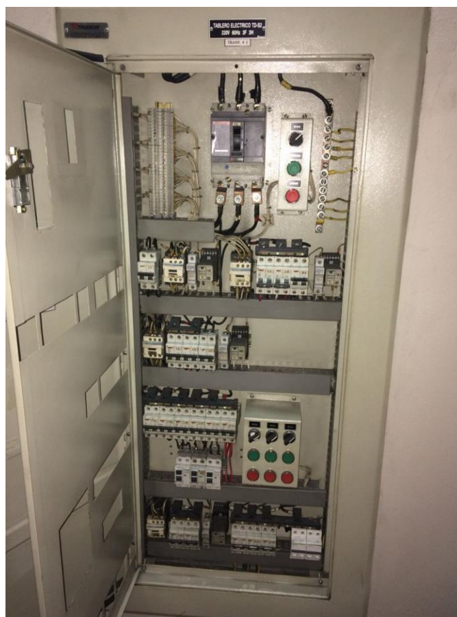
Figura 52: Tablero de iluminación TD-S2.
