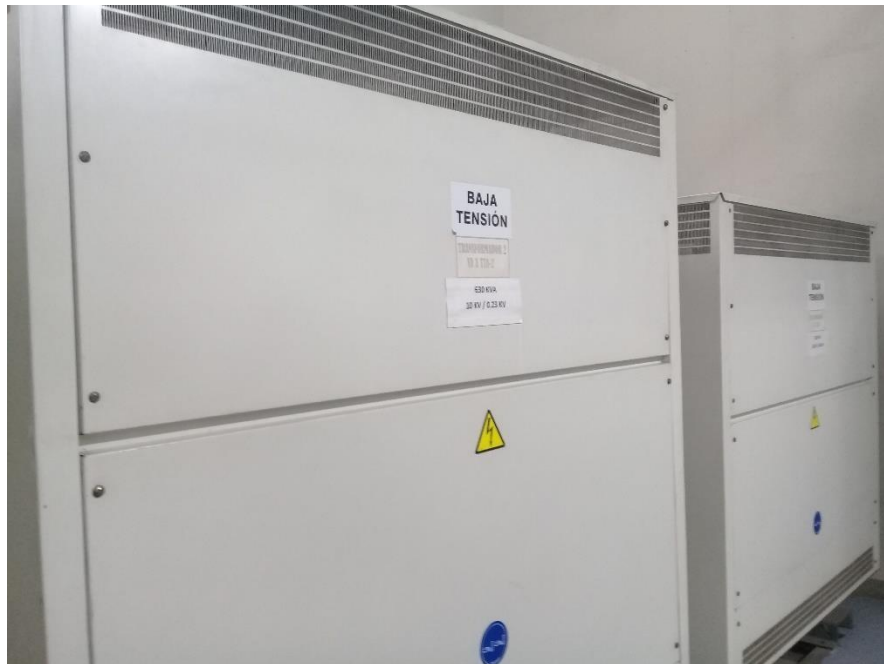
Figura 45: Transformadores de baja tensión.
