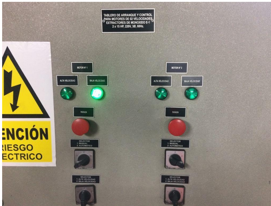
Figura 33: El tablero del extractor de monóxido
