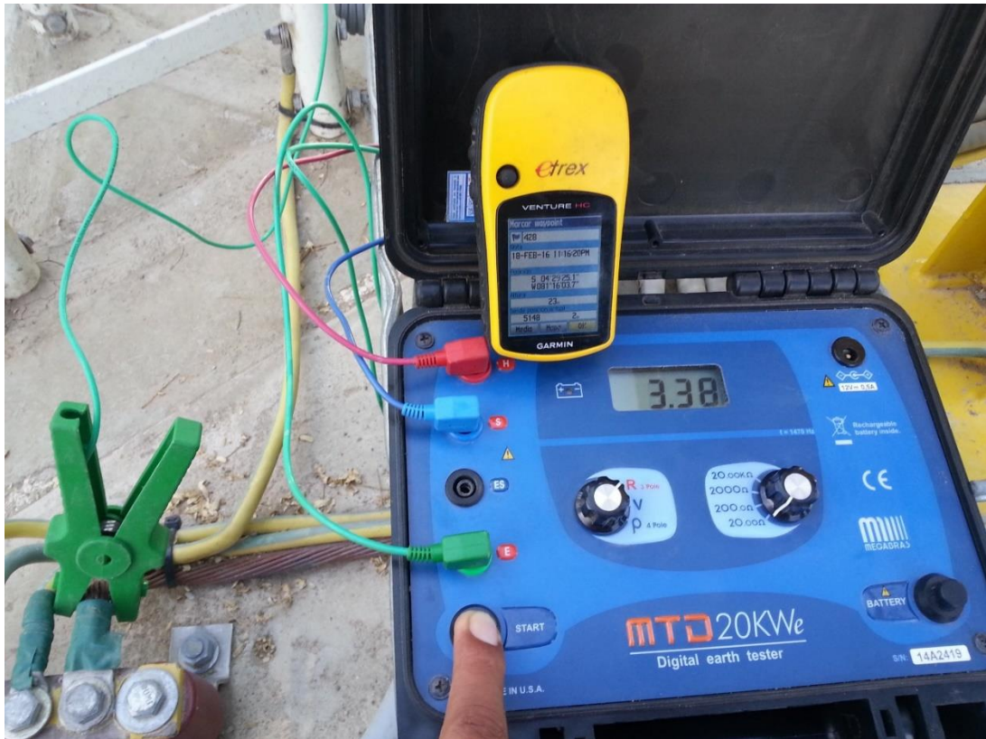
Figura 42. Medición de pozo a tierra del repetidor. Fuente: Elaboración propia.
