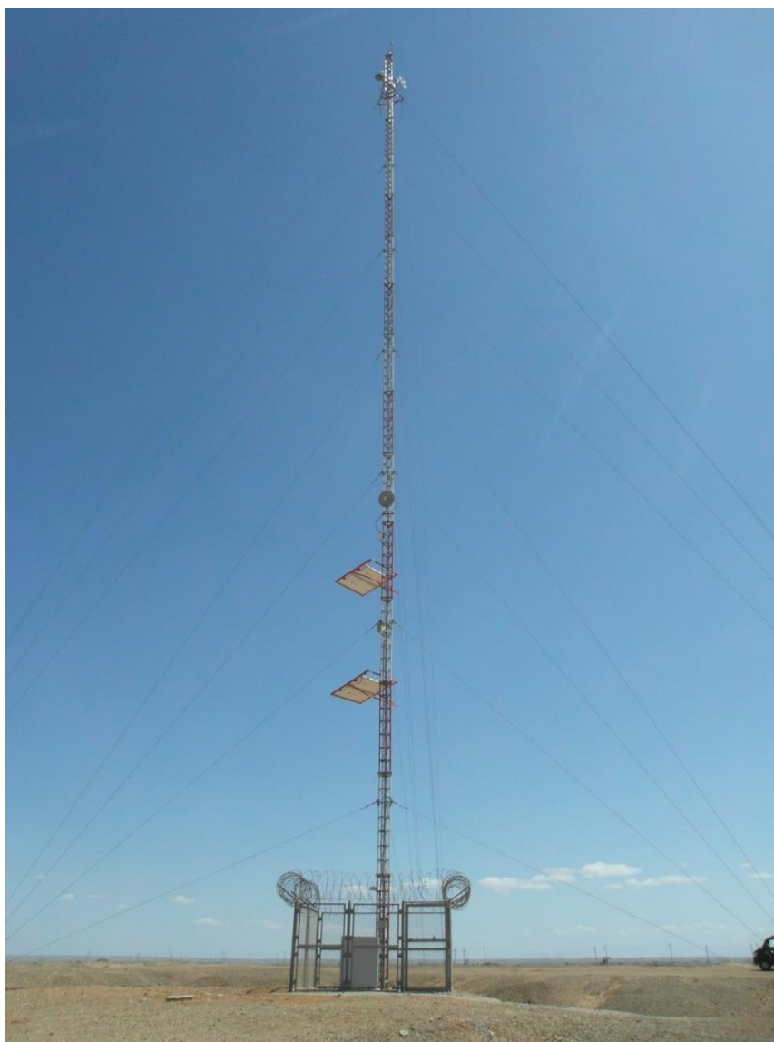
Figura 35. Vista panorámica del repetidor. Fuente: Elaboración propia.
