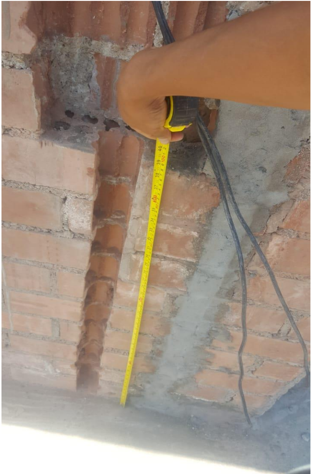
Se observa la longitud de los 99 cm del nivel del suelo a la cajuela estando dentro de los parámetros establecido por Luz del Sur
