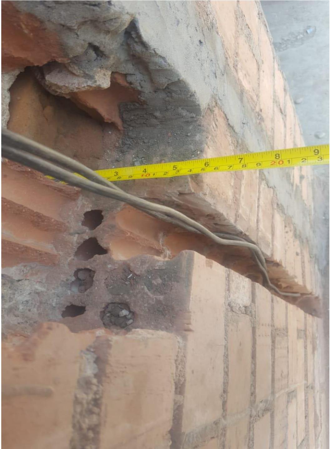
Se observa la longitud de los 14.9 cm de profundidad de la cajuela estando dentro de los parámetros establecido por Luz del Sur
