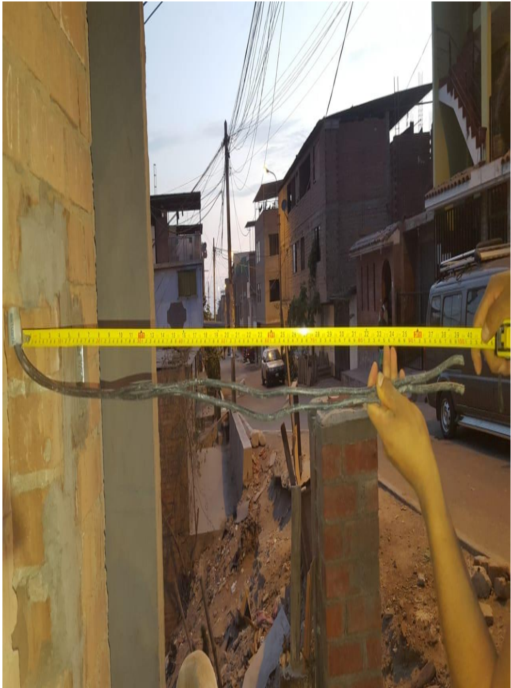
Se observa la longitud de los 100 cm del cable interno del cliente estando dentro de los parámetros establecido por Luz del Sur.
