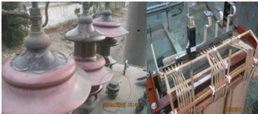
Figura 50: Conmutador o Tap de derivación.
