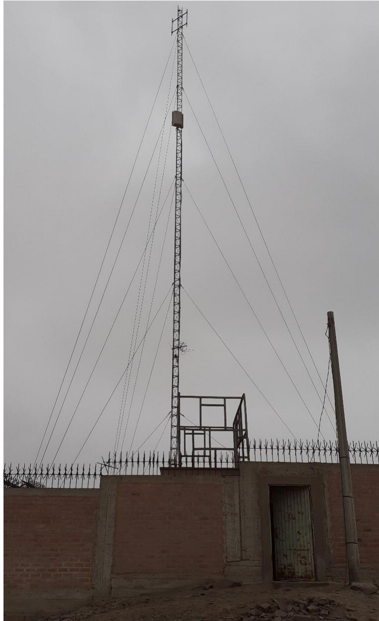
Figura 3.43. Montaje de la antena yagui y Kathrein en la torre ventada.
