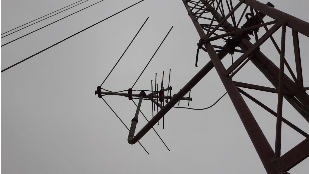
Figura 3.40. Montaje de la antena yagui multicanal VHF-UHF en la torre ventada.
