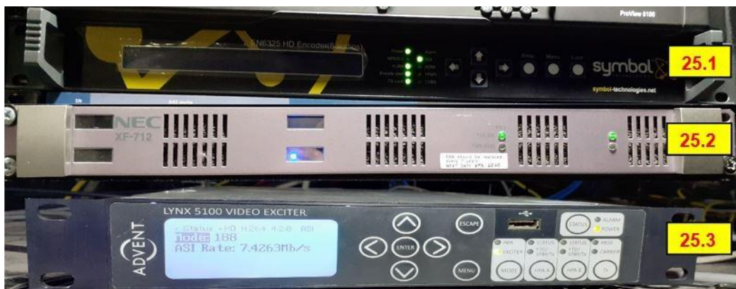
Figura 3.4. Equipos Encoder Symbol, Nec y Vislink. Fuente: Elaboración propia.
