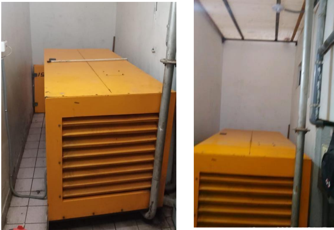
Figura 5. Ambiente donde se encuentra el grupo electrógeno Elaboración propia
