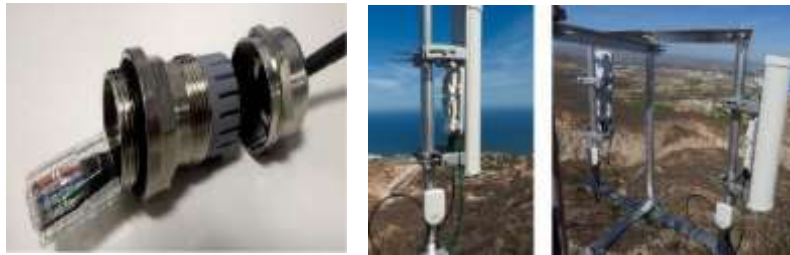
Figura 34 Montaje final de la antena PMP 450i.
