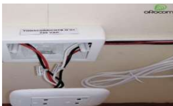
Figura 48 Etiquetado de los puntos eléctricos.
