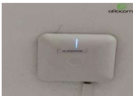
Figura 43 Imagen de la instalación del Cnpilot E600.
