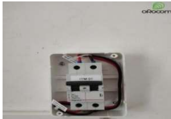
Figura 44 Imagen de la instalación de ITM C10.
