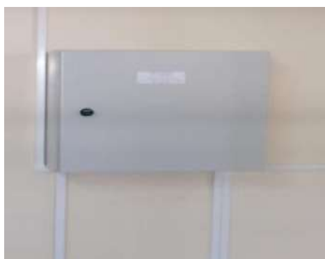
Figura 41 Implementación del gabinete de red.
