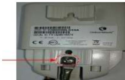
Figura 35 Aterramiento del surge supresor Terminal de aterramiento
